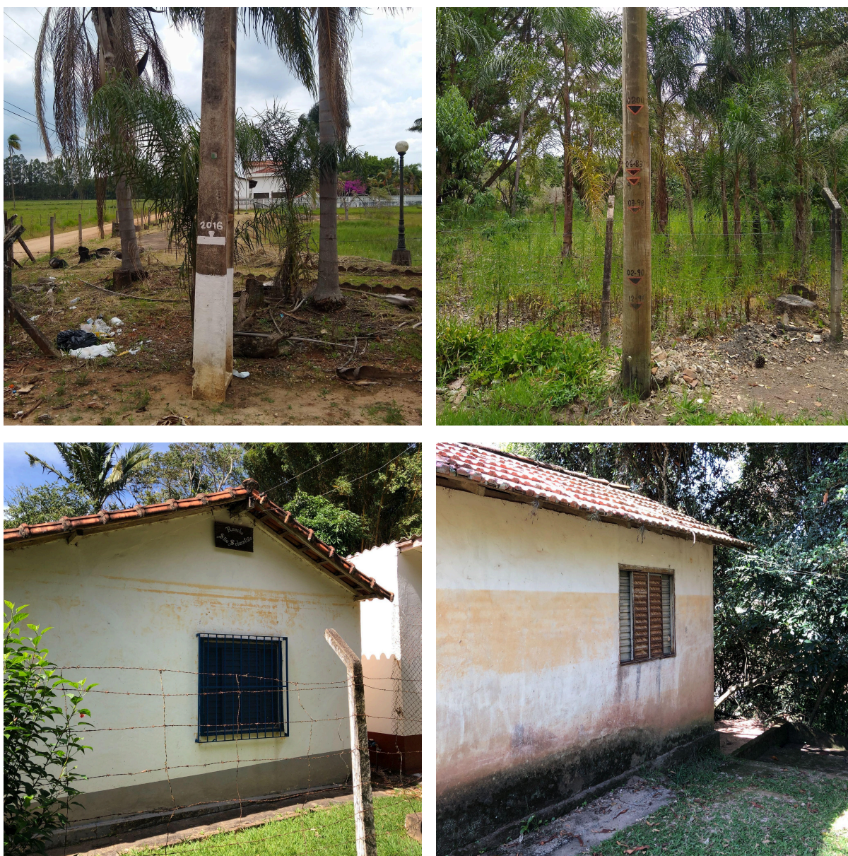
Figura 4: Evidências das Inundações em Campina do Monte Alegre
