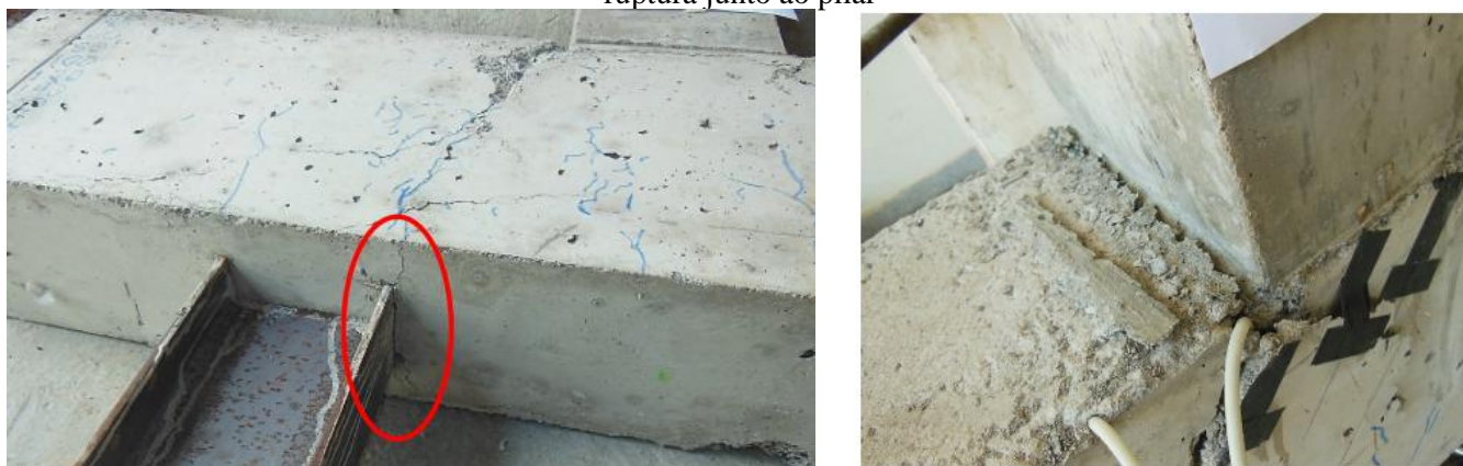
(a) BA_{s,sold}4A_{s,estr} : fissuras junto à estaca
