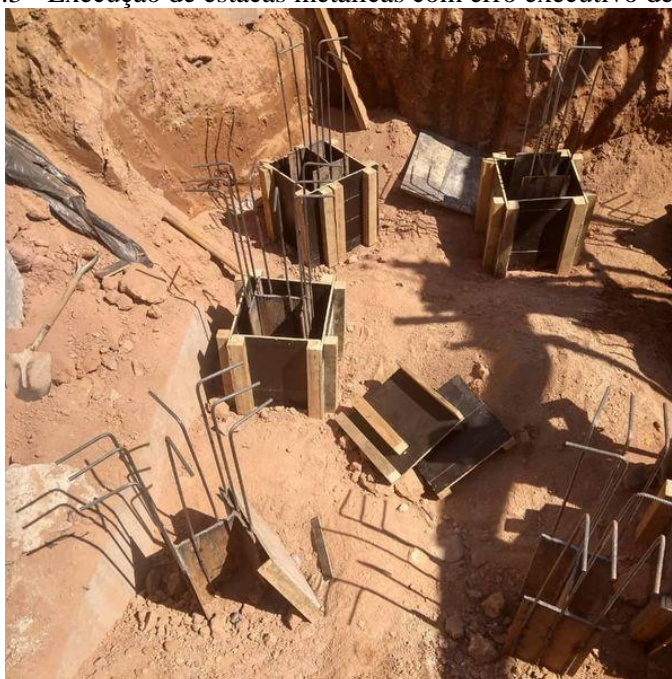
Figura 1.3 - Execução de estacas metálicas com erro executivo de cravação
