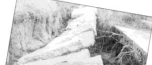
As guias e sarjetas já estão destruídas em boa parte das ruas.
