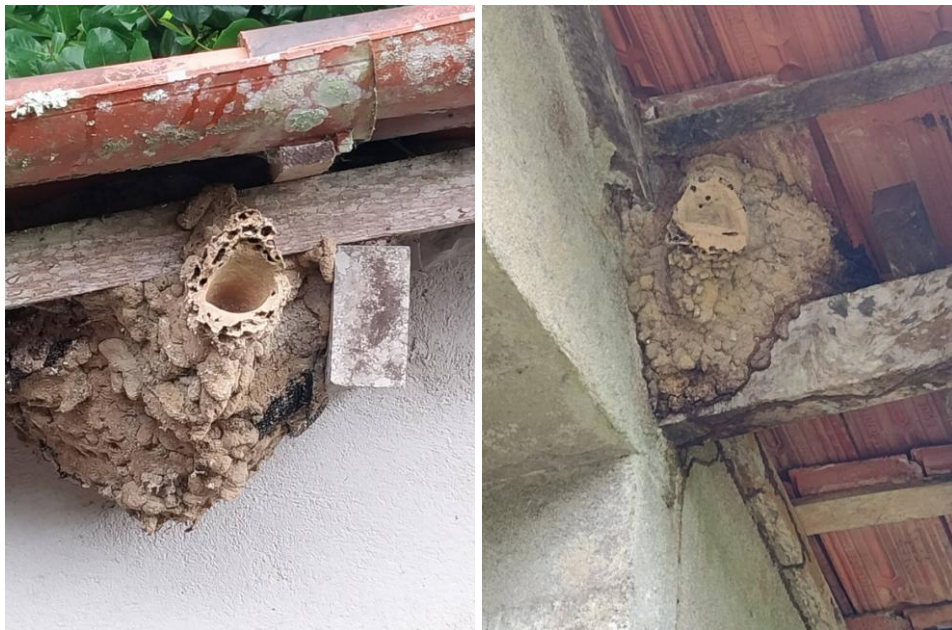
Figura 31 – Ninhos de Boca-de-sapo ( Partamona helleri ) em vigas de telhado.
