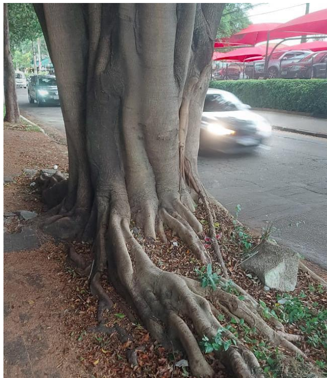
Foto 2- Raízes de Ficus benjamina L. danificando calçada.
