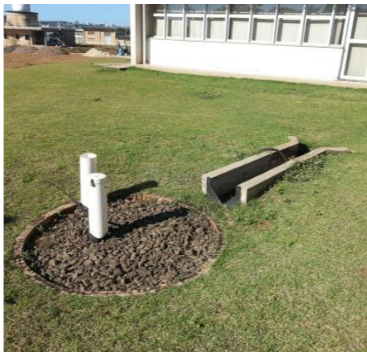
Figura 2.7 Poço de Infiltração no Campus da UFSCar
