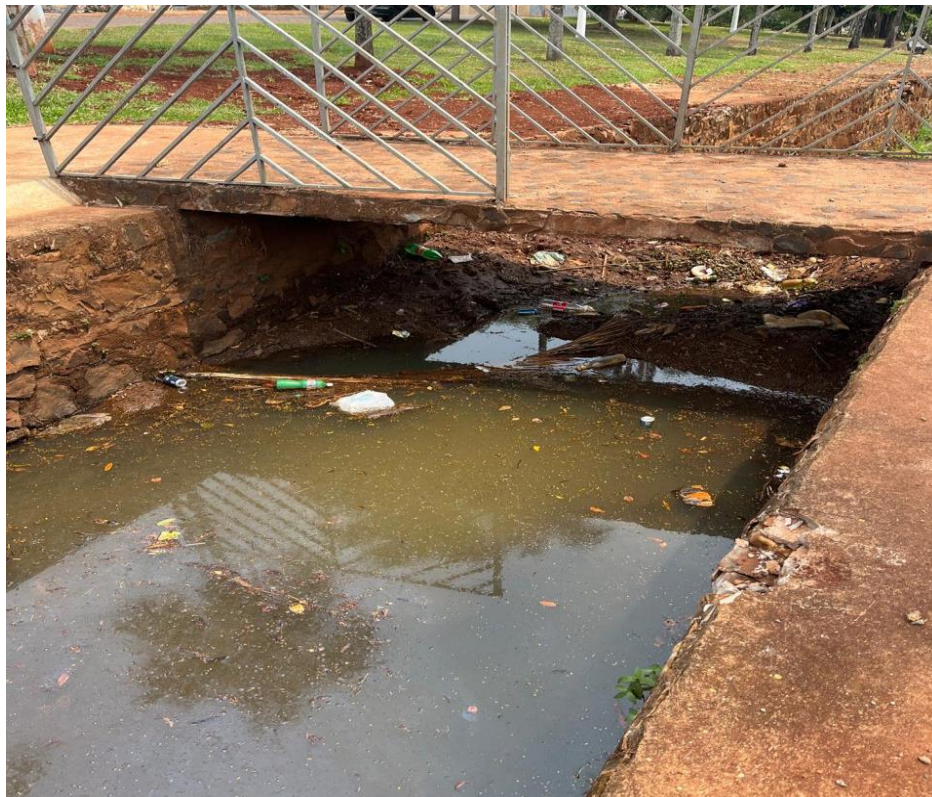
Figura 20. Trecho impactado do Córrego Barreiro em Arandu
