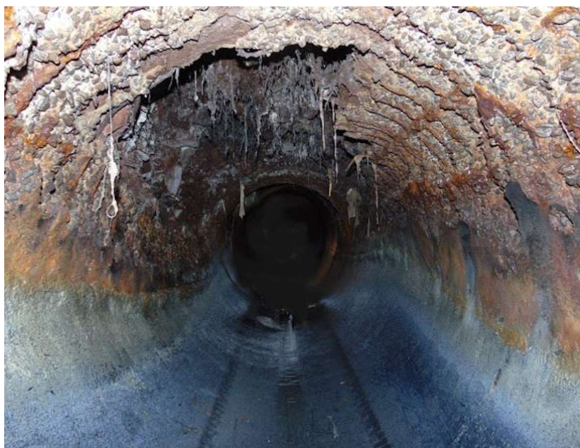
Figura 4 - Corrosão de Tubulação de Concreto em Rockland, Nova York
