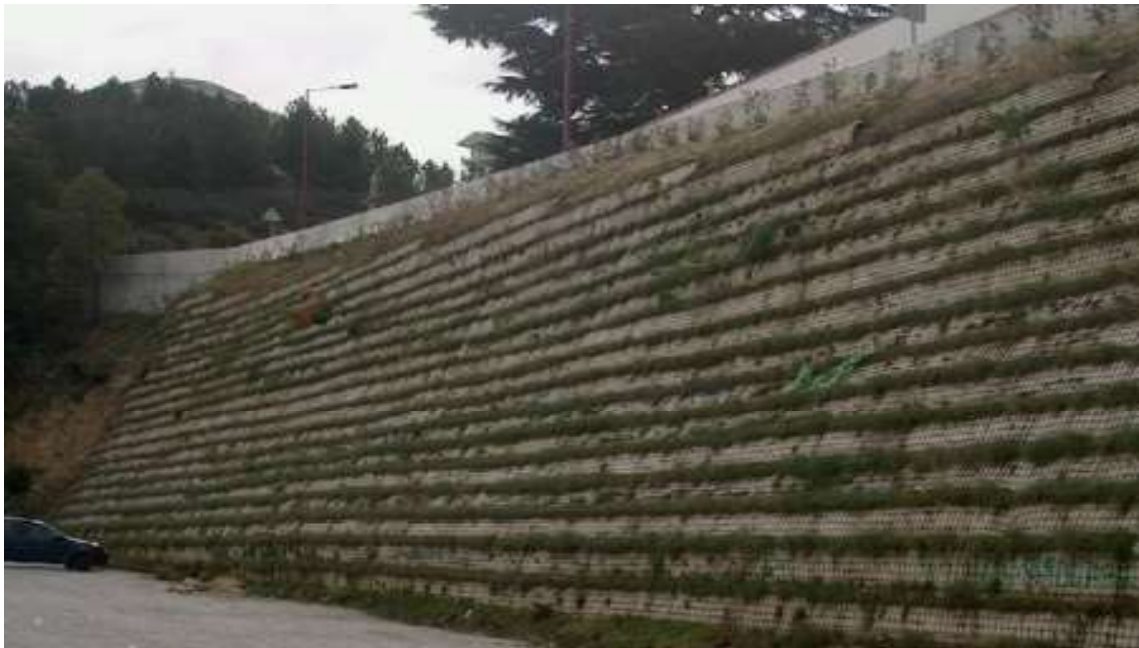
Figura 9 – Estrutura de solos reforçados com geossintéticos com incorporação de vegetação na face (adaptado de Vieira, 2008)
