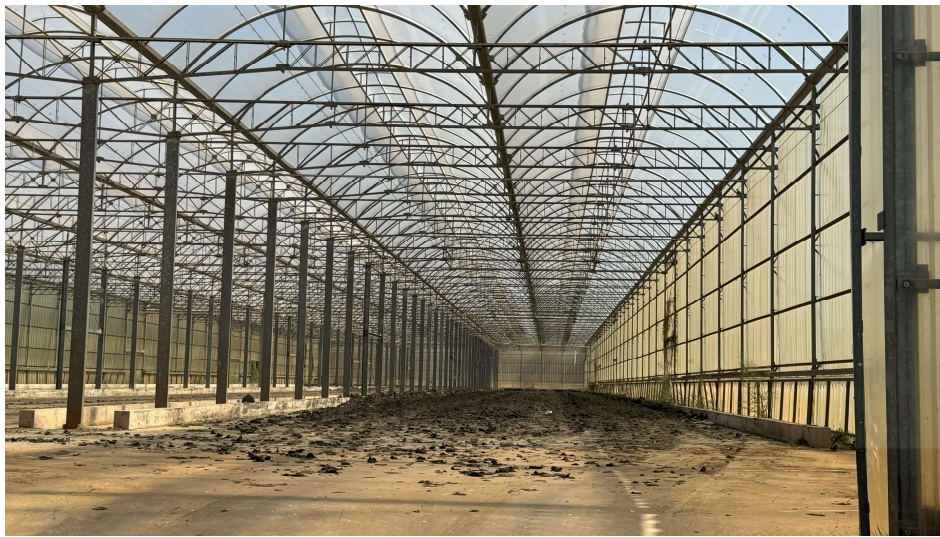
Figura 33 - Galpão existe de secagem do lodo inativo.
