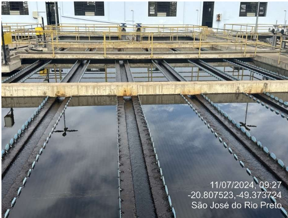
Figura 24 - Etapa de filtração no tratamento da água.
