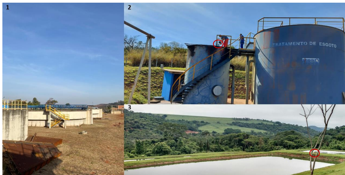
Figura 11. Locais de coleta dos efluentes. (1) Saída reator UASB Monjolinho, (2) Saída reator UASB Água Vermelha e (3) Lagoa anaeróbia e facultativa de Santa Eudóxia. Fotos do autor.
