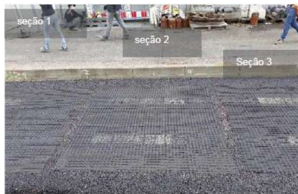
Figura 2.10 - Seções teste construídos com geossintéticos Huesker para realização de fresagem. Fonte: Test report 2100991 (2022).
