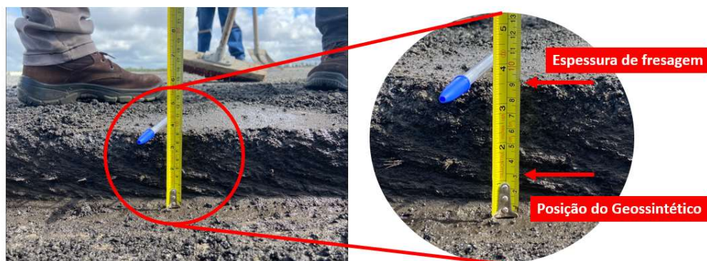
Figura 3.23 - Espessura de fresagem executada e posição do geossintético durante a pesquisa. Fonte: Elaborado pelo autor (2024).
