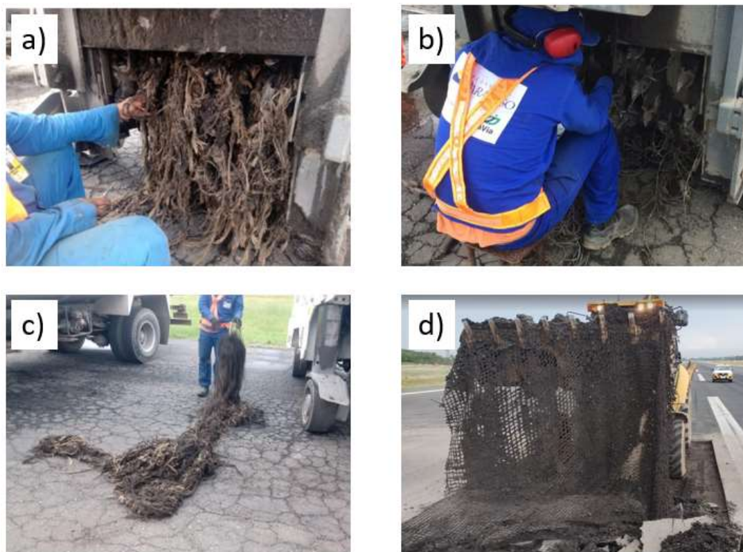
Figura 3.5 - Fresagem pista de pouso e decolagem PPD - 10/28: a) tambor de fresagem com geossintéticos enroscado; b) limpeza do tambor; c) filamentos de geossintéticos removidos da fresadora; d) momento da remoção por demolição. Fonte: Elaborado pelo autor (2024).
