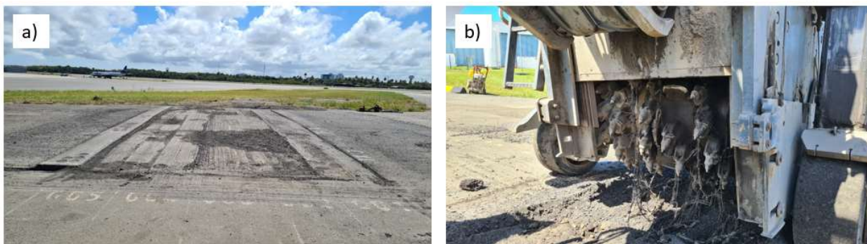
Figura 4.6 - Aspectos da fresagem da seção teste 5: a) seção teste após a fresagem e b) tambor de fresagem após, com fragmentos de geogrelha de poliéster GG5. Fonte: Elaborado pelo autor (2024).
