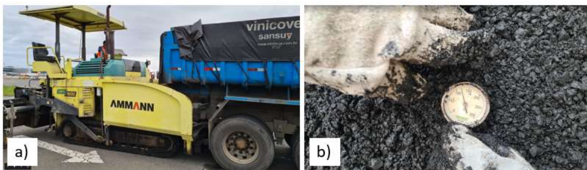
Figura 3.16 - Controle de qualidade no processo de aplicação da camada de revestimento: a) caminhão lonado antes do processo de aplicação; b) controle de temperatura. Fonte: Elaborado pelo autor (2024).
