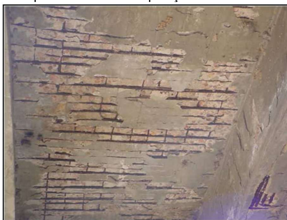
Figura 4 - Exemplo de deslocamento com exposição das armaduras em uma laje de ponte
