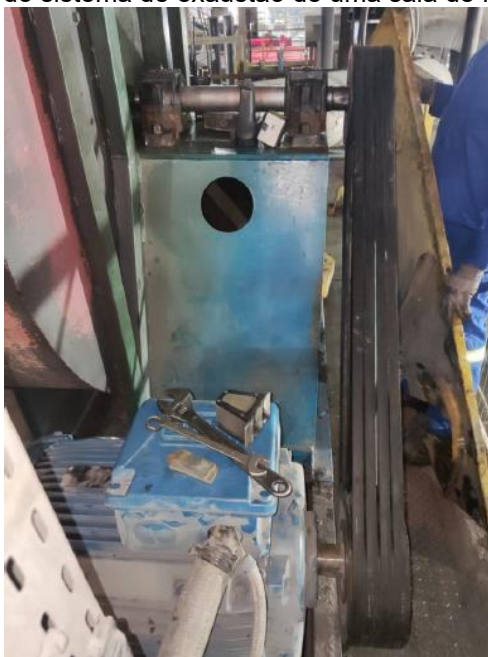
Figura 12 - Ventilador do sistema de exaustão de uma sala de fornos de uma indústria
