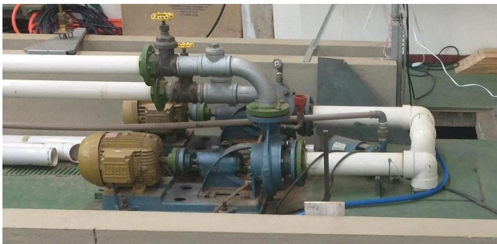
Figura 5 – Bomba responsável pela circulação da água no sistema.
