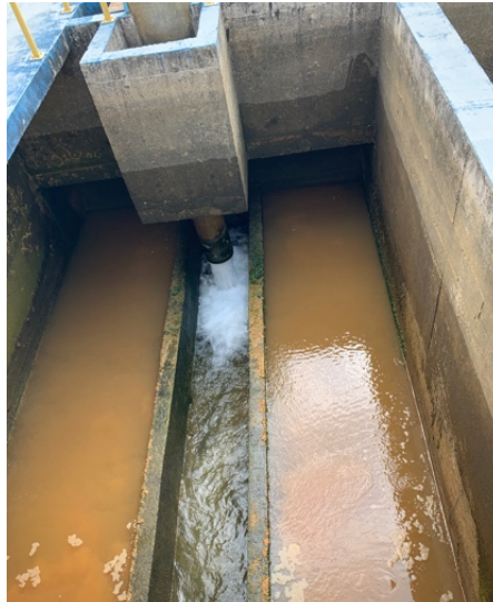
Figura 15 – Filtro sendo lavado
