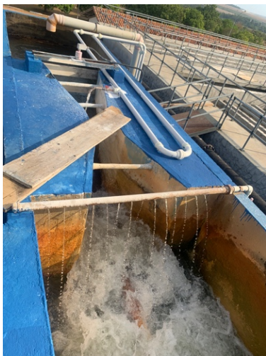
Figura 11– Coagulação em Calha Parshall
