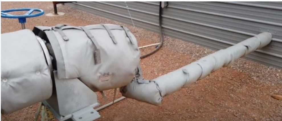
Figura 89 - Tubulação contendo o CO 2 que será injetado na câmara de carbonatação.
