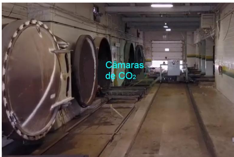
Figura 51 - Câmara de cura carbônica localizadas na empresa Boehmers Hargest Blocks Ltd
