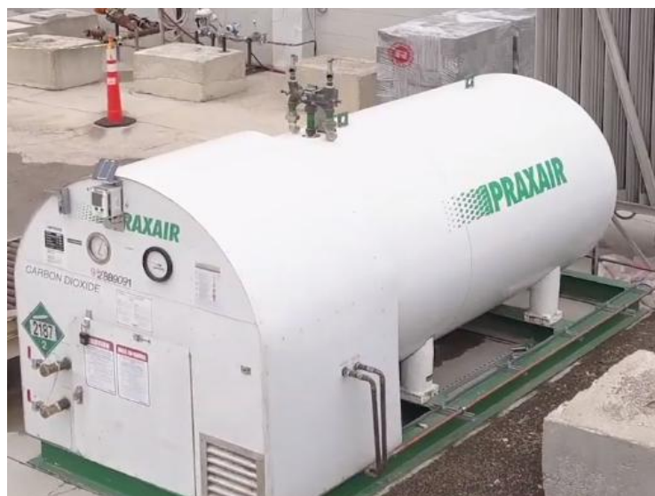
Figura 87 - Tanque para armazenamento de CO 2 capturado.
