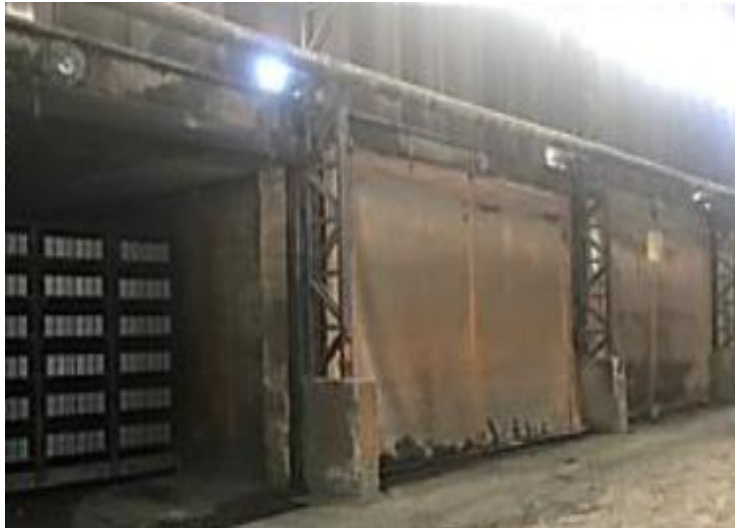
Figura 94 - Câmaras de cura à vapor em fábrica de blocos de concreto.
