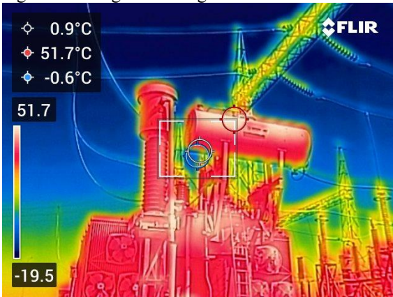
Figura 1 – Imagem Termográfica de Transformador.
