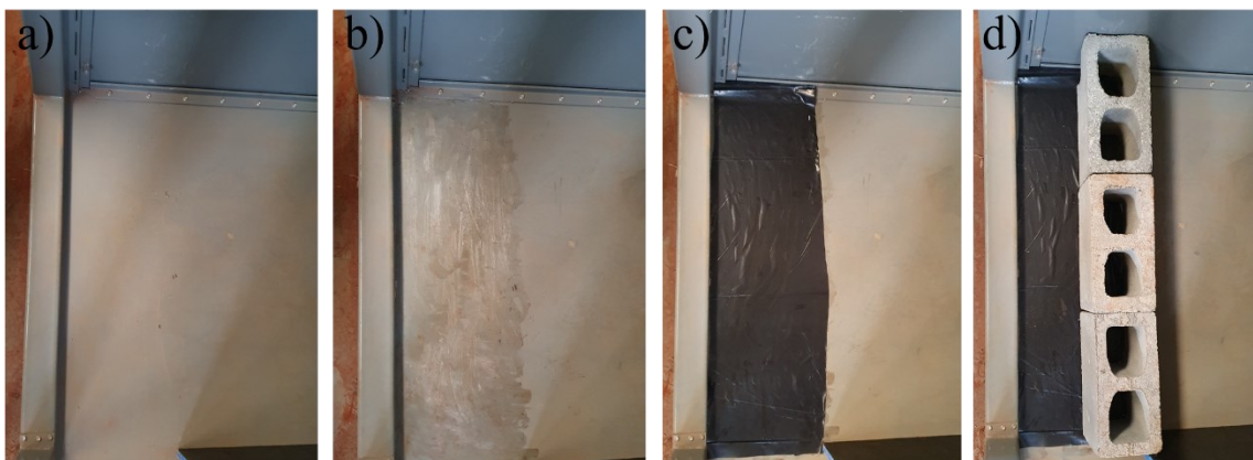
Figura 3.5: Processo de lubrificação base: a) Limpeza interna; b) Aplicação vaselina; c) Revestimento com membrana plástica; d) Posicionamento blocos da face (1 fiada).
