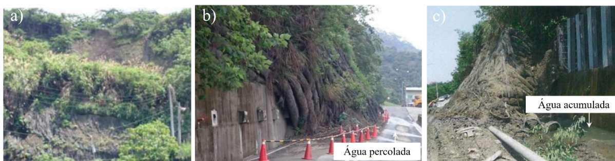
Figura 2.33: Ruptura ESRG desencadeada por chuvas em Taichung, Taiwan: a) Vista geral; b) Base da ruptura com escoamento de água do interior da massa de solo; c) Vista lateral (adaptado YANG et al., 2019a).
