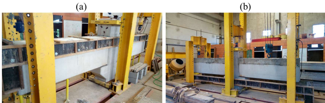
Figura C.11: (a) Cura da concretagem de segunda etapa (b) Retirada das fôrmas do Modelo 2 inteiramente montado
