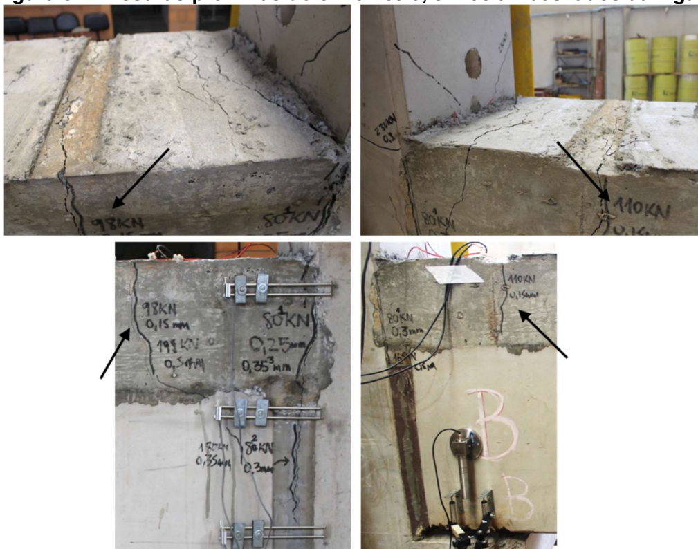
Figura 5.4: Fissuras próximas do clinômetro, em os ambos lados da viga B
