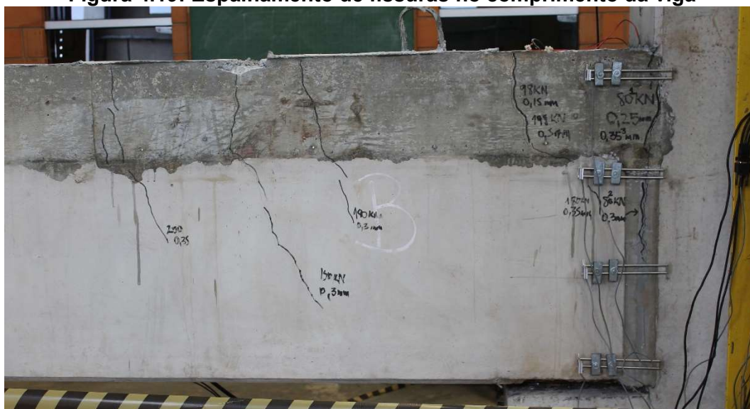
Figura 4.19: Espalhamento de fissuras no comprimento da viga
