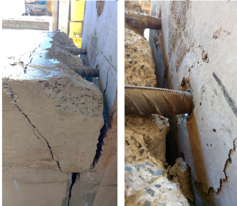
Figura 4.10: Fissuras na região da ligação após a segunda etapa de ensaio
