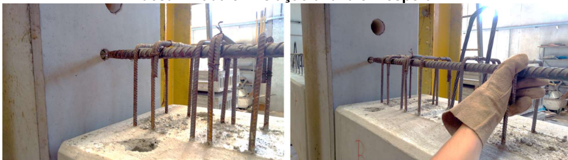
Figura C.3: Posicionamento da armadura negativa na viga B. Armadura muito desalinhada em relação à luva em espera
