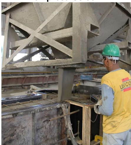
Figura 3.22: Lançamento de concreto na forma de um dos pilares no pátio da empresa Usicon
