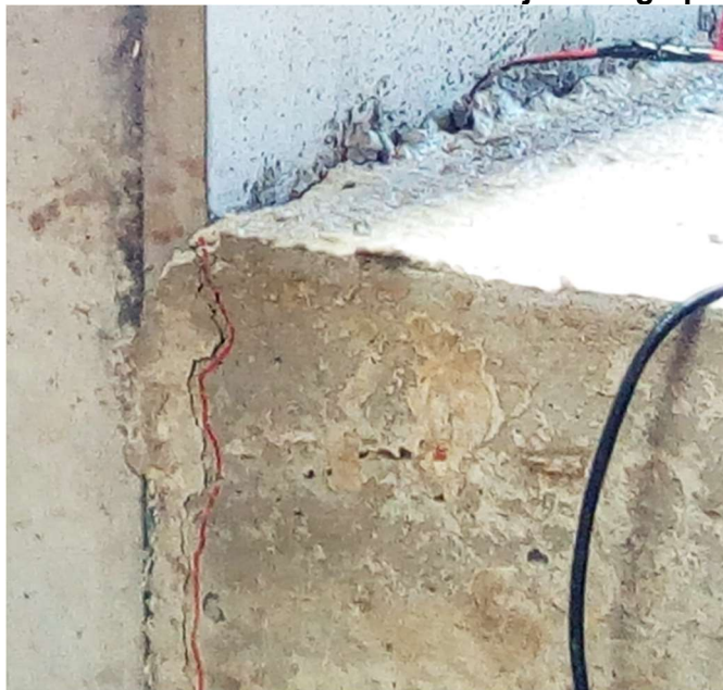
Figura 4.4: Detalhe 1 - Abertura de fissura na junta viga-pilar da viga B
