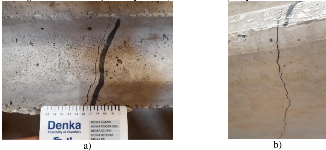
Figura 7-23: Fissuração da laje L05. a) nas laterais. b) na parte inferior
