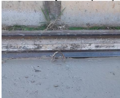
Figura 5-56: Parta exposta da alça de içamento
