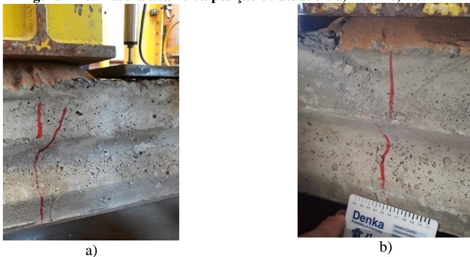
Figura 7-28: Fissura abaixo da posição do atuador: a) L05A b) L05B
