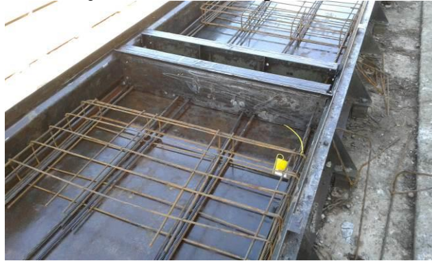
Figura 5-21: Extremidade de laje alveolar moldada por fôrma fixa com armaduras de reforço
