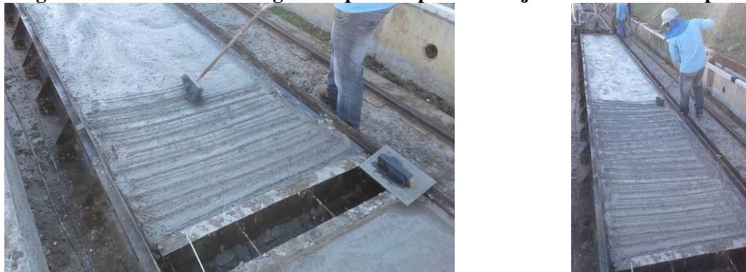
Figura 5-40: Acabamento rugoso na parte superior da laje alveolar moldada por fôrma fixa
