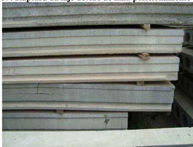
Figura 5-59: Ruptura da laje devido ao mau posicionamento dos apoios
