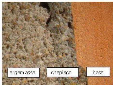
Figura 21- Interface argamassa/chapisco e interface chapisco/bloco
