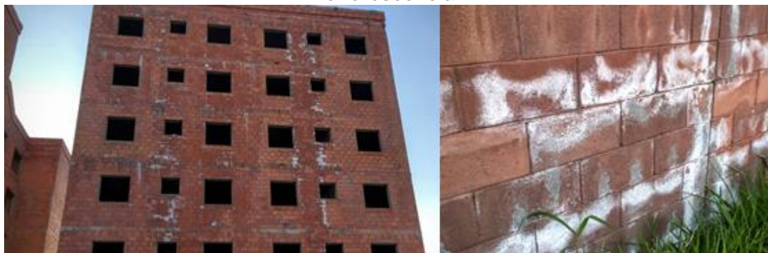
Figura 5- Paredes de blocos cerâmicos e de concreto com manifestação de eflorescência
