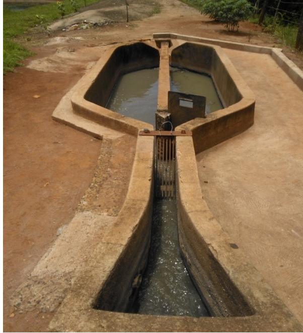
Figura 6: Grade e desarenador da ETE de Santa Eudóxia.
