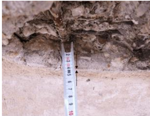
Figura 20 - Exemplo de concreto carbonatado em ponte
