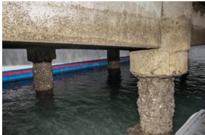
Figura 22 - Exemplo de ponte submetida à ação direta de íons cloreto
