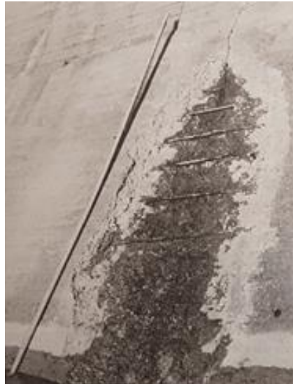
Figura 12 - Exemplo de estrutura degradada por ataque por sulfatos
