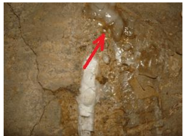
Figura 10 - Exemplo de superfície de elemento de concreto que sofreu reação álcali-agregado, na qual é possível observar o gel lixiviado
