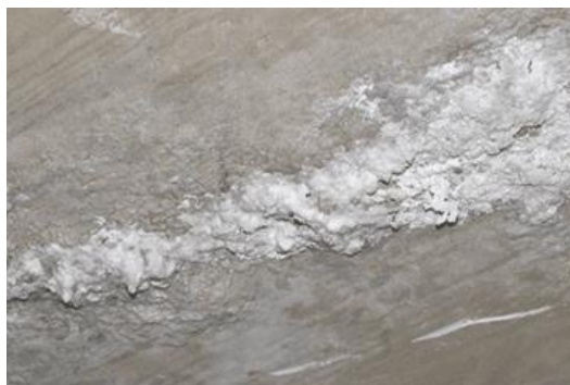
Figura 6 - Fotografia da superfície inferior de uma laje que apresenta eflorescência
