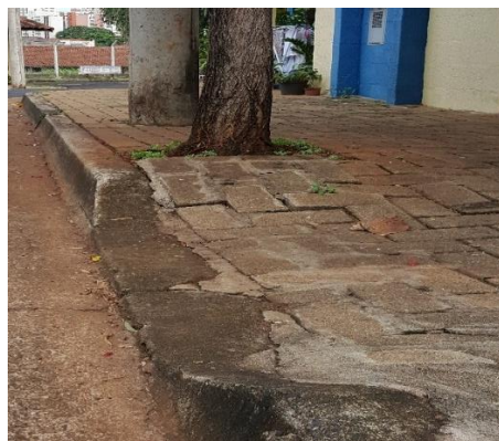
Foto 16: calçada do Recanto Feliz com guia rebaixada
