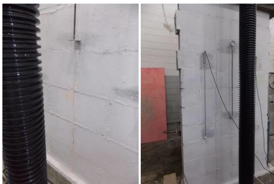
Figura 59. Ilustração da fissuração vertical das paredes Grupo 1 e 2.
