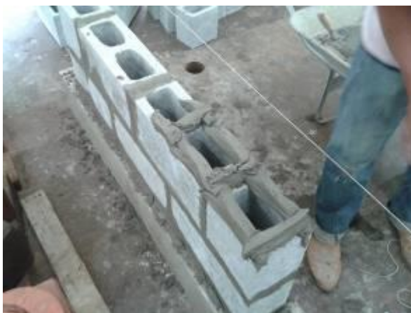
Figura 43. Ilustração das paredes com assentamento parcial (argamassa somente nas as paredes longitudinais dos blocos)
