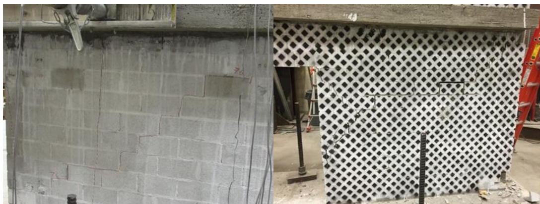
Figura 113 –Forma de ruptura da parede 6 dotada de abertura de porta e acoplada por viga de alvenaria
