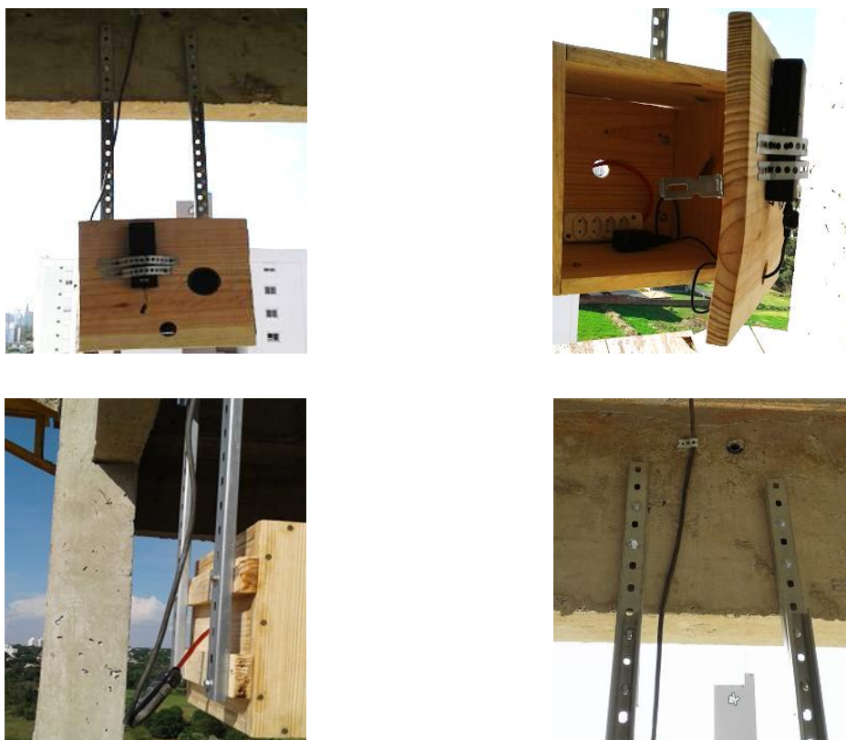
Figura 4.13 – Caixa de madeira construída para instalar e proteger os equipamentos durante os ensaios de campo
