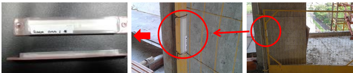
Figura 5.16 – Tag RFID instalada em sistema Guarda-Corpo Rodapé (GcR) no canteiro de obras
