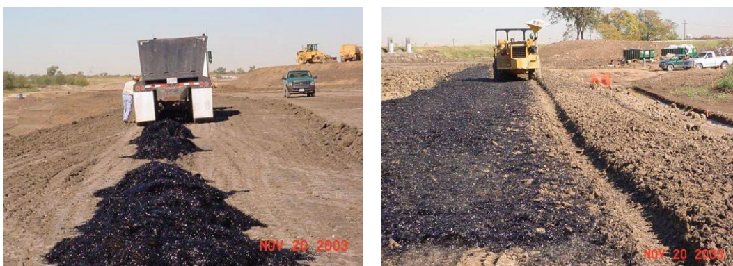
Figura 2.1. Aplicação das fibras de polipropileno na construção de aterros de rodovia (Gregory, 2006).
