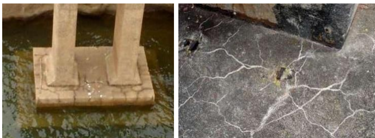
Figura 2.1 a) e b) Estruturas afetadas pela RAA na UHE Jaguari - SP.
