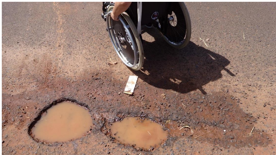
Figura 52 – Via com buracos
