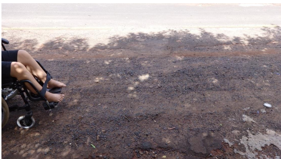
Figura 51 – Via com asfalto irregular
