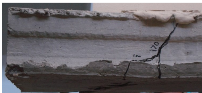
b) Fissuras do modelo M2-A de Silva (2015)
