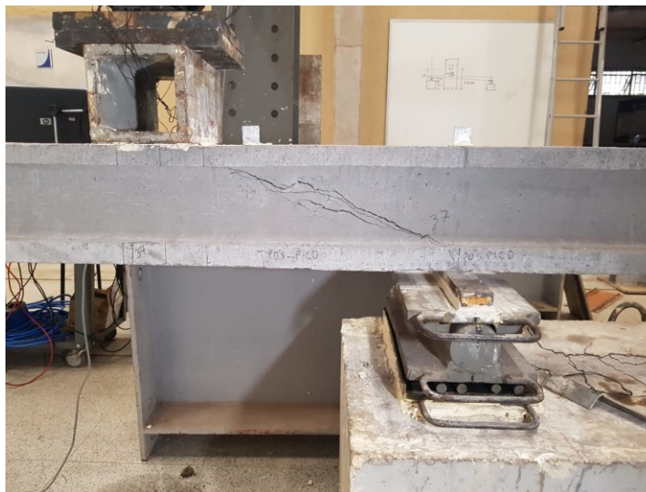
Figura 6-12 - Fissuras do modelo TR2-6
