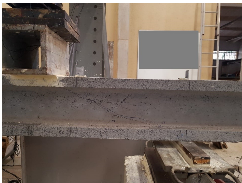
Figura 6-14 - Fissuras do modelo TR2-8
