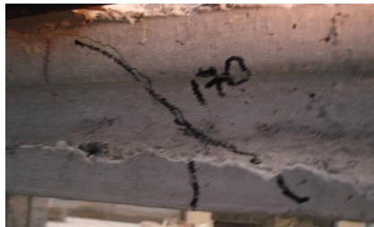
Figura 2-8 - Fissura de flexão
