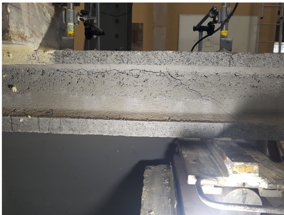
Figura 6-15 - Fissuras do modelo TR2-9
