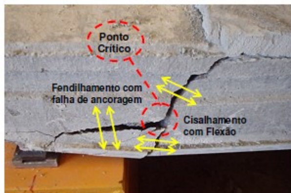
Figura 2-15 - Combinação de flexo-cortante fendilhamento e perda de ancoragem
