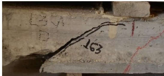
Figura 2-14 - Deslocamento do concreto
