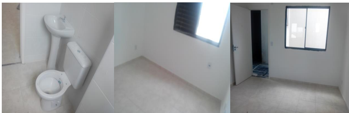
Foto 224 (esquerda)– Aspecto de limpeza em banheiro, Torre 1, bloco C, 3º piso, na obra 2; Foto 225 (centro) – Aspecto de limpeza em quarto, Torre 1, bloco C, 3º piso, na obra 2; Foto 226 (direita) – Aspecto de limpeza em sala, torre 1, bloco C, 3º piso, na obra 2 (Fonte: o pesquisador, 2019)
