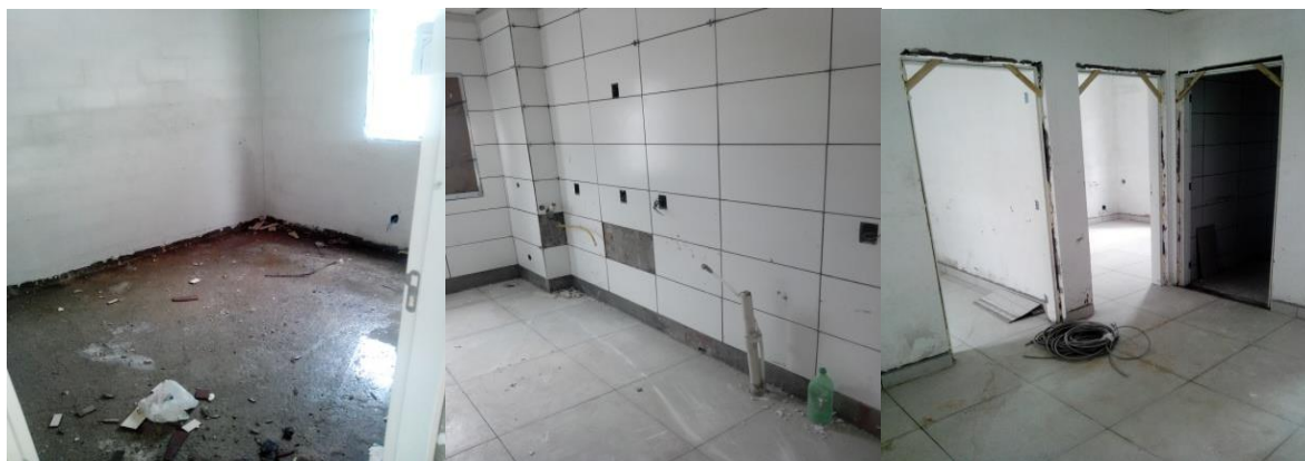
Foto 242 (esquerda)– Aspecto de limpeza em quarto, Torre 2, Bloco B, 3º piso, na obra 2; Foto 243 (centro) – Aspecto de limpeza em cozinha, Torre 2, bloco B, 3º piso, na obra 2; Foto 244 (direita) – Aspecto de limpeza em sala, Torre 2, bloco B, 3º piso, na obra 2 (Fonte: o pesquisador, 2019)
