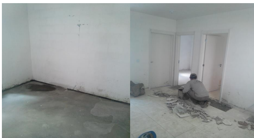
Foto 203 (esquerda) – Piso e rodapé cerâmico por colocar, em quarto, Bloco C, torre 1, na obra 2; Foto 204 (direita) – Assentamento de piso cerâmico na sala, Bloco D, torre 1, na obra 2 (Fonte: o pesquisador, 2019)
