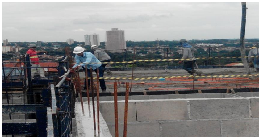
Figura 603 – Uso apenas de fita sinalizadora, como proteção anti-quedas, na execução de laje (o pesquisador, 2019).
