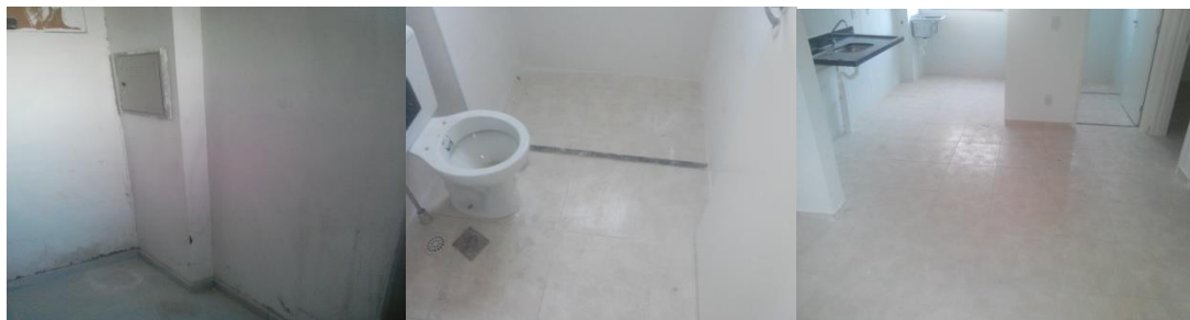
Foto 269 (esquerda)– Aspecto de limpeza em área comum, Torre 3, Bloco C, 3º piso, na obra 2; Foto 270 (centro) – Aspecto de limpeza em banheiro, Torre 3, Bloco C, 3º piso, na obra 2; Foto 271 (direita) – Aspecto de limpeza em sala e cozinha, Torre 3, Bloco C, 3º piso, na obra 2 (Fonte: o pesquisador, 2019)
