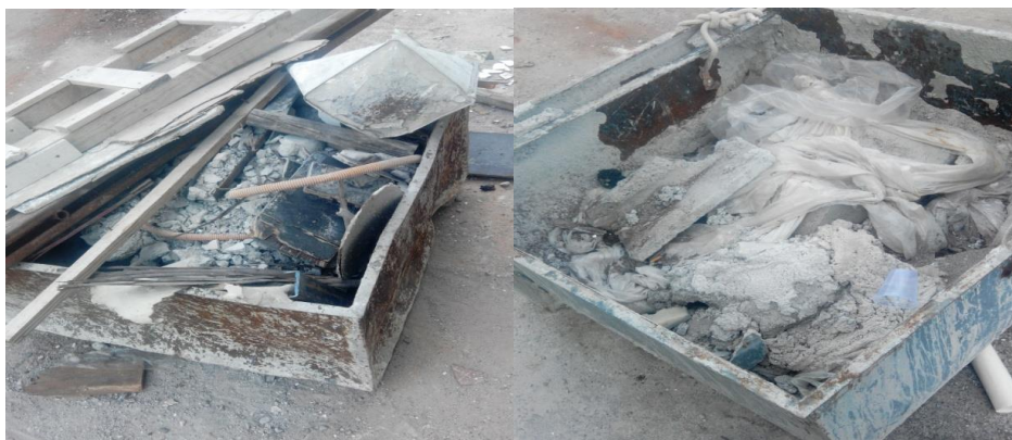
Foto 274 (esquerda)– Contaminação de resíduos em caixotão, na obra 2; Foto 275 (direita) – Contaminação de resíduos em caixotão, na obra 2 (Fonte: o pesquisador, 2019)
