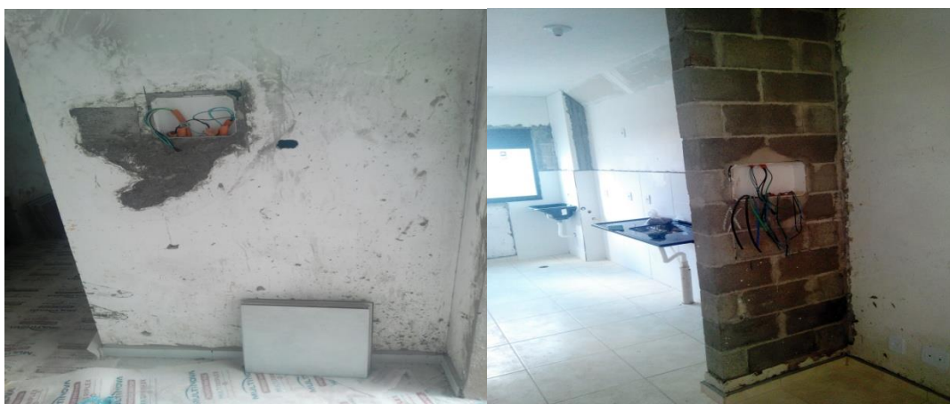
Foto 201 (esquerda) – Quadro elétrico por aplicar, em área comum, Bloco A, torre 1, na obra 2; Foto 202 (direita) – Paredes por rebocar e pintar, quadro elétrico por colocar, Bloco B, torre 1, na obra 2 (Fonte: o pesquisador, 2019)
