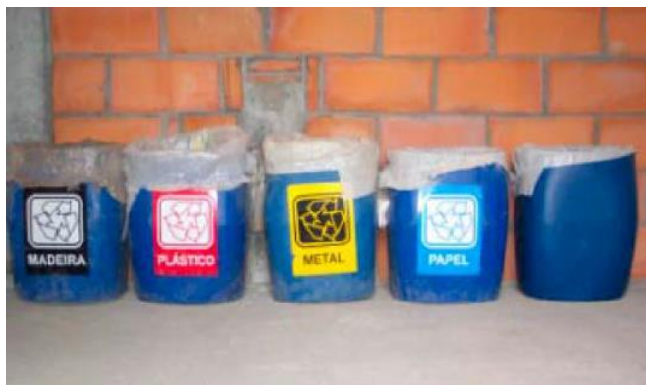
Figura 301 – Bombonas para o descarte de resíduos nos pavimentos (Fonte: Scalone, 2013)
