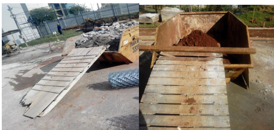
Fotos 134 (esquerda) – Resíduos classe A, cimentícios / entulhos, sofrendo armazenamento final em caçamba própria para o efeito, na obra 2; Foto 135 (direita) – Resíduos classe A do tipo solos, sofrendo armazenamento final em caçamba exclusiva para eles, no térreo, na obra 2 (o pesquisador, 2019)
