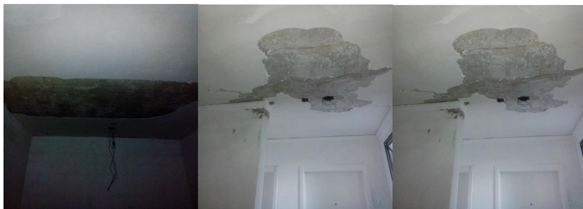
Foto 181 (esquerda) – Necessidade de retrabalhos nos tetos das zonas de áreas comuns, na obra 2; Foto 182 (centro) – Necessidade de retrabalhos nos tetos das zonas de áreas comuns, na obra 2; Foto 183 (direita) – Necessidade de retrabalhos nos tetos das zonas de áreas comuns, na obra 2 (Fonte: o pesquisador, 2019).
