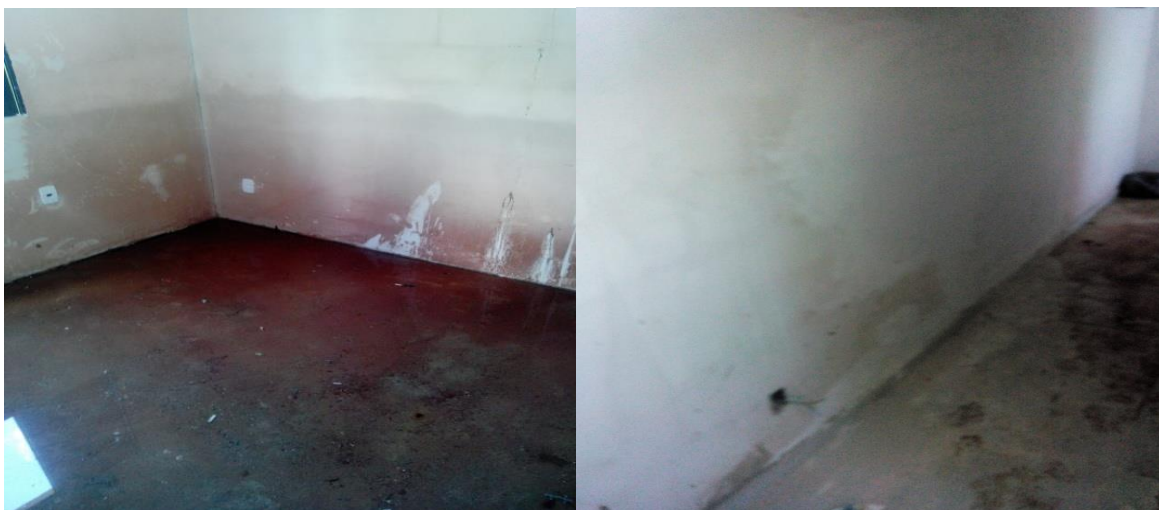
Foto 179 (esquerda) – Umidade em paredes interiores dos cômodos, na obra 2; Foto 180 (direita) – Umidade nas paredes em zonas de áreas comuns, na obra 2 (Fonte: o pesquisador, 2019)
