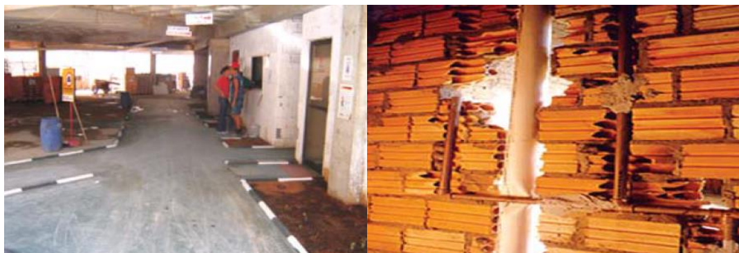
Figura 9 – (esquerda) Demarcação de vias de acesso aos armazenamentos; (direita) Execução de serviço de alvenaria sem projeto de paginação (Fonte: Novaes, M. de V.; Mourão, C.A.M. do A., 2008)
