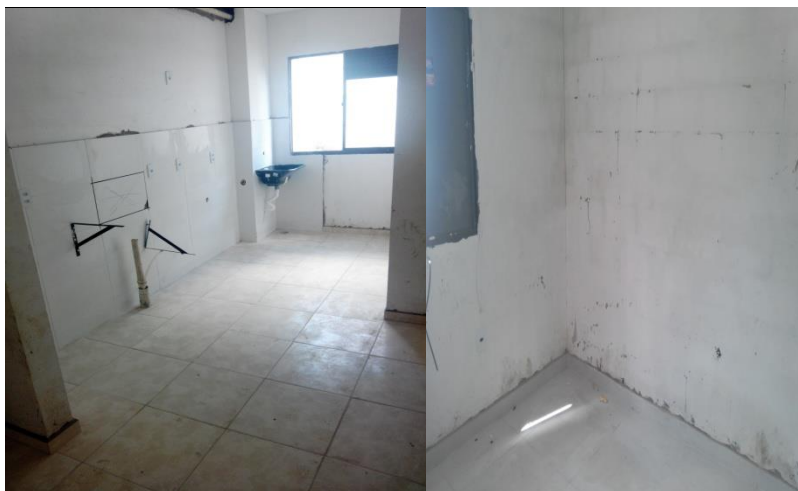
Foto 207 (esquerda) – Sanca no teto por executar, e pia por assentar, em cozinha, Bloco C, torre 1, na obra 2; Foto 208 (direita) – Pinturas por executar, em quarto, Bloco D, torre 1, na obra 2 (Fonte: o pesquisador, 2019)
