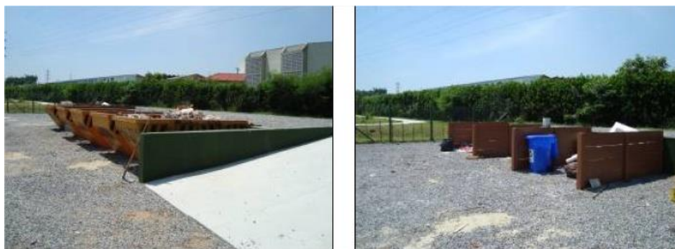
Figura 320 (esquerda) – Ecoponto 31 de Março, com caçambas para resíduos densos – S. José dos Campos – SP; (direita) - Baías de armazenamento de resíduos leves do mesmo (Fonte: Córdoba, 2010)
