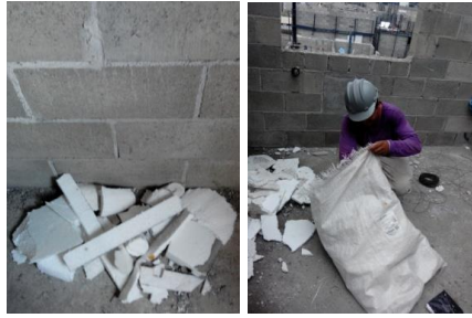
Foto 89 (esquerda) – Resíduos de isopor triados/segregados, junto às paredes dos cômodos, nos pisos superiores ao térreo; Foto 90 (direita) – Resíduos de isopor sendo acondicionados inicialmente em sacos de ráfia, nos pisos superiores ao térreo (Fonte: o pesquisador, 2019)
