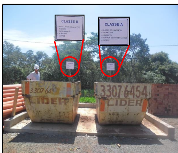
Foto 38 - Situação preconizada no PGRS para armazenamento final de resíduos classes A e B (o pesquisador)
