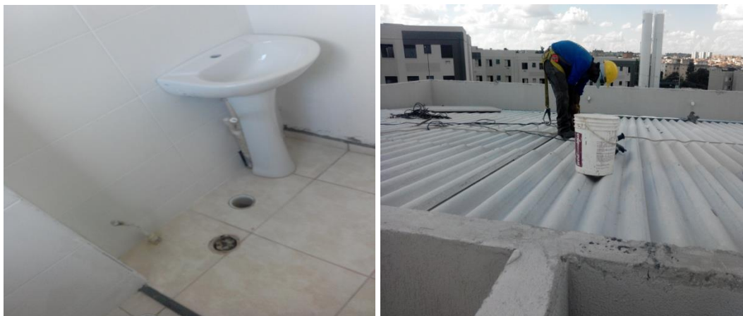
Foto 199 (esquerda) – Louças sanitárias, umas assentes outras não, Bloco C, torre 2, na obra 2; Foto 200 (direita) – Fixação de peças de fibrocimento, em cobertura, bloco A, torre 2, na obra 2 (Fonte: o pesquisador, 2019)
