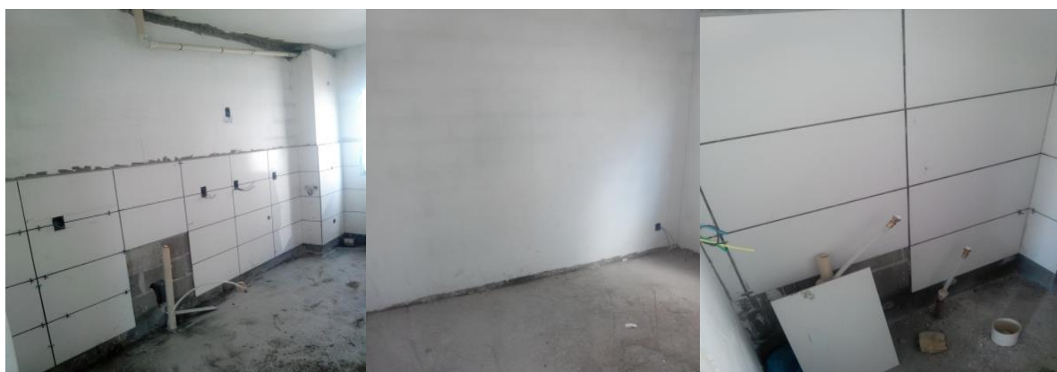
Foto 236 (esquerda) – Aspecto de limpeza em sala e cozinha, Torre 2, bloco A, 2º piso, na obra 2; Foto 237 (centro) – Aspecto de limpeza em quarto, Torre 2, bloco A, 2º piso, na obra 2; Foto 238 (direita) – Aspecto de limpeza em banheiro, Torre 2, bloco A, 2º piso, na obra 2 (Fonte: o pesquisador, 2019)
