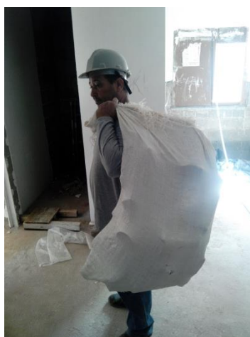
Foto 81 – Resíduos de plásticos duros/rígidos, sendo transportados horizontalmente, nos pisos superiores ao térreo, por funcionário, de forma manual, até cômodo acessível a equipamento do tipo “sky-trek” (Fonte: o pesquisador, 2019)
