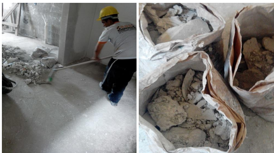
Foto 63 (esquerda) – Triagem/segregação de resíduos de gesso (classe B) por varrição, nos pavimentos superiores ao térreo; Foto 64 (direita) – Acondicionamento de resíduos de gesso dentro de sacos de cimento vazios, nos pavimentos superiores ao térreo (Fonte: o pesquisador, 2019)
