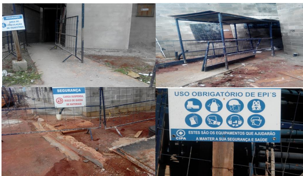
Foto 107 (superior esquerda) – Sinalização de segurança: área de circulação de pedestres; Foto 108 (superior direita) – Passadiço de proteção contra risco de queda de objetos em altura; Foto 109 (inferior esquerda) – Sinalização de segurança para carga suspensa, risco de queda de materiais; Foto 110 (inferior direita) – Sinalização de uso obrigatório de EPI's (Fonte: o pesquisador, 2019)
