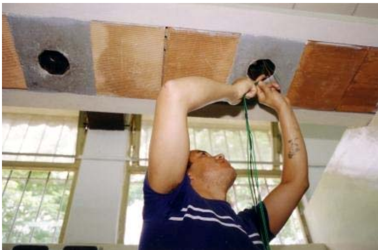
EDUCAÇÃO/FORMAÇÃO Alunos do Curso de Requalificação Profissional do FAT aprendendo eletricidade predial. Foto: Benedito Maia
