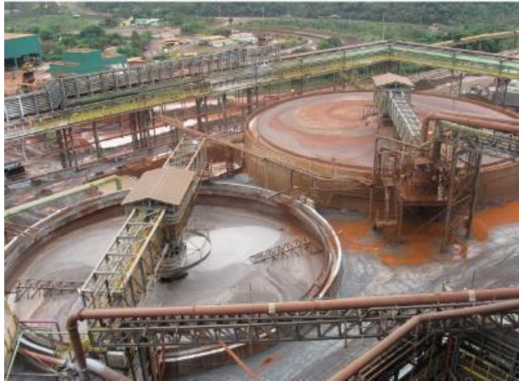
FIGURA 4.3-2 - Espessadores de concentrado instalados na Usina de Germano - SAMARCO
