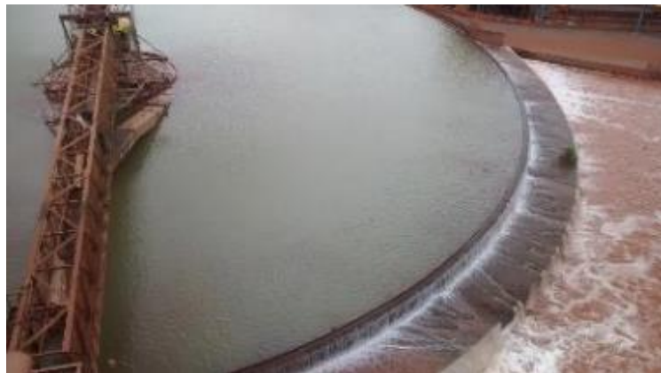
FIGURA 4.3-3 - Espessadores de lama para deságuamento de água instalado na Usina de Brucutu – Vale
