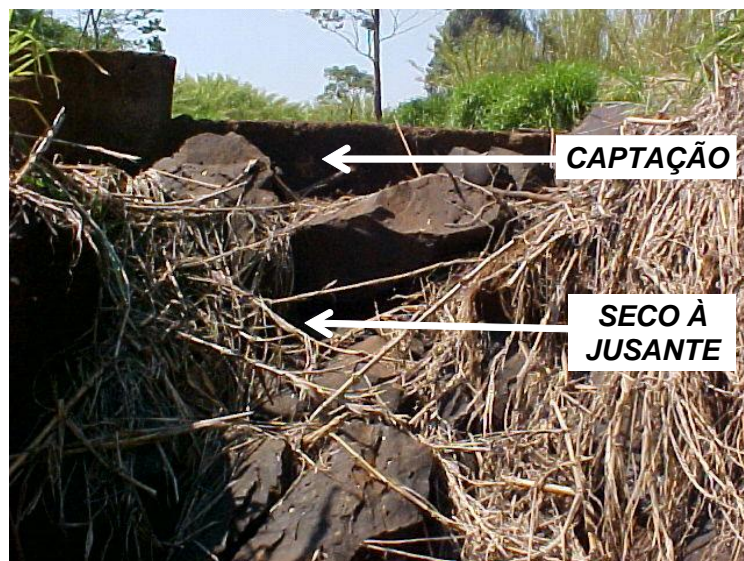
Figura 36: Córrego João da Velha – captação de água, 22/10/2002
