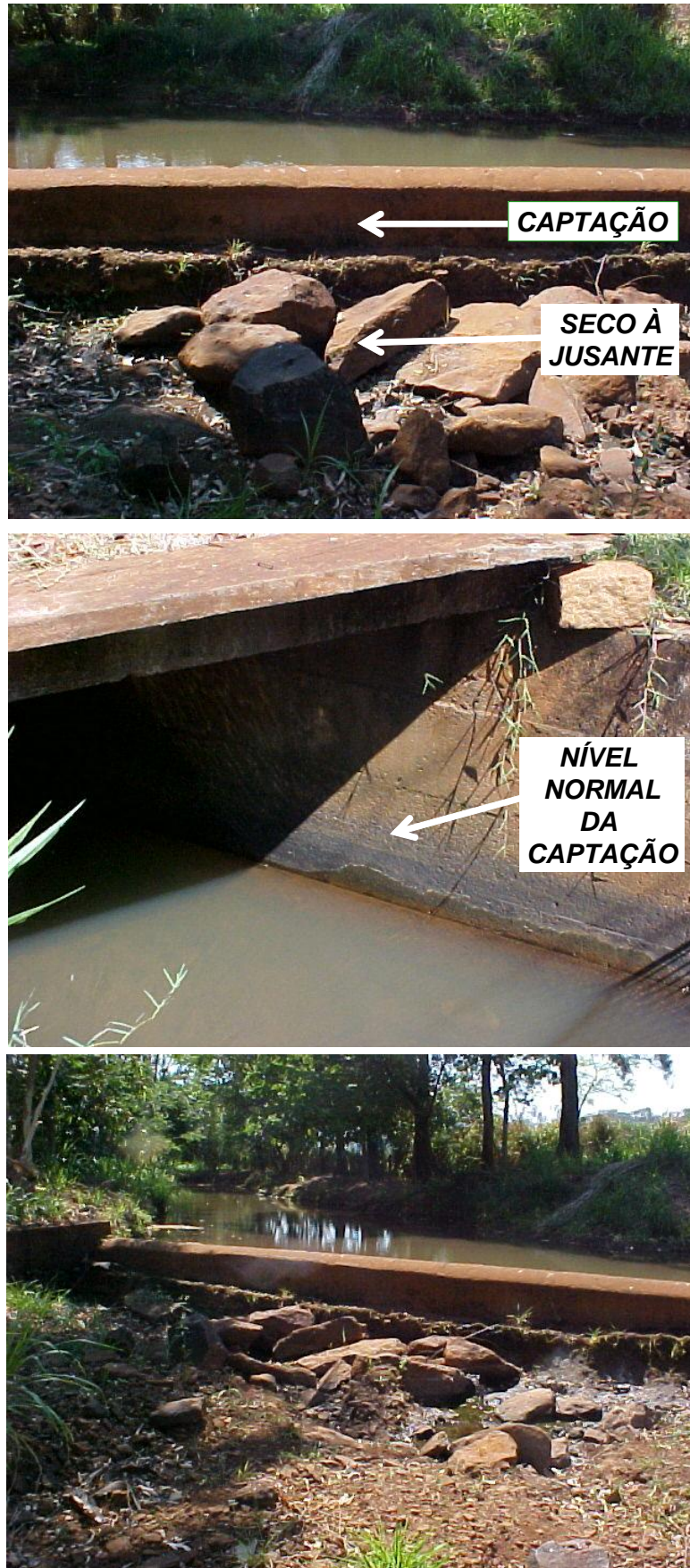
Figura 37: Córrego Santo Antônio – captação de água, 22/10/2002
