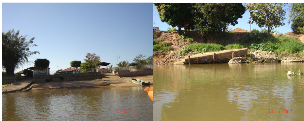
Figura 14 - Construção civil à margem do rio Paraguai e muro de arrimo destruído na zona urbana.
