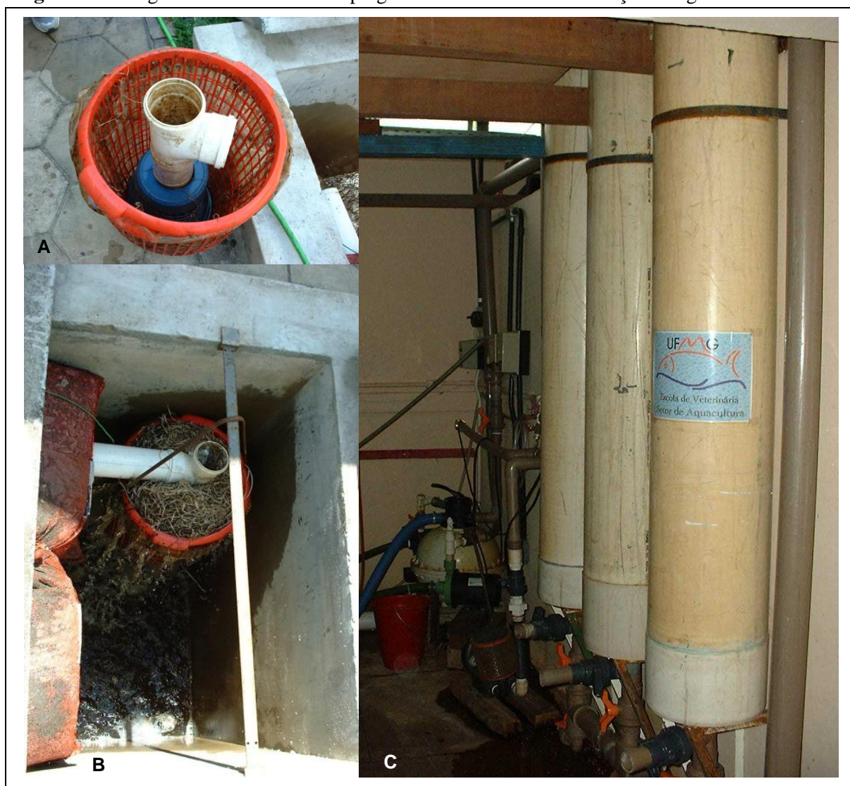
Figura 3.2 – Algumas das estruturas empregadas no sistema de recirculação de água
