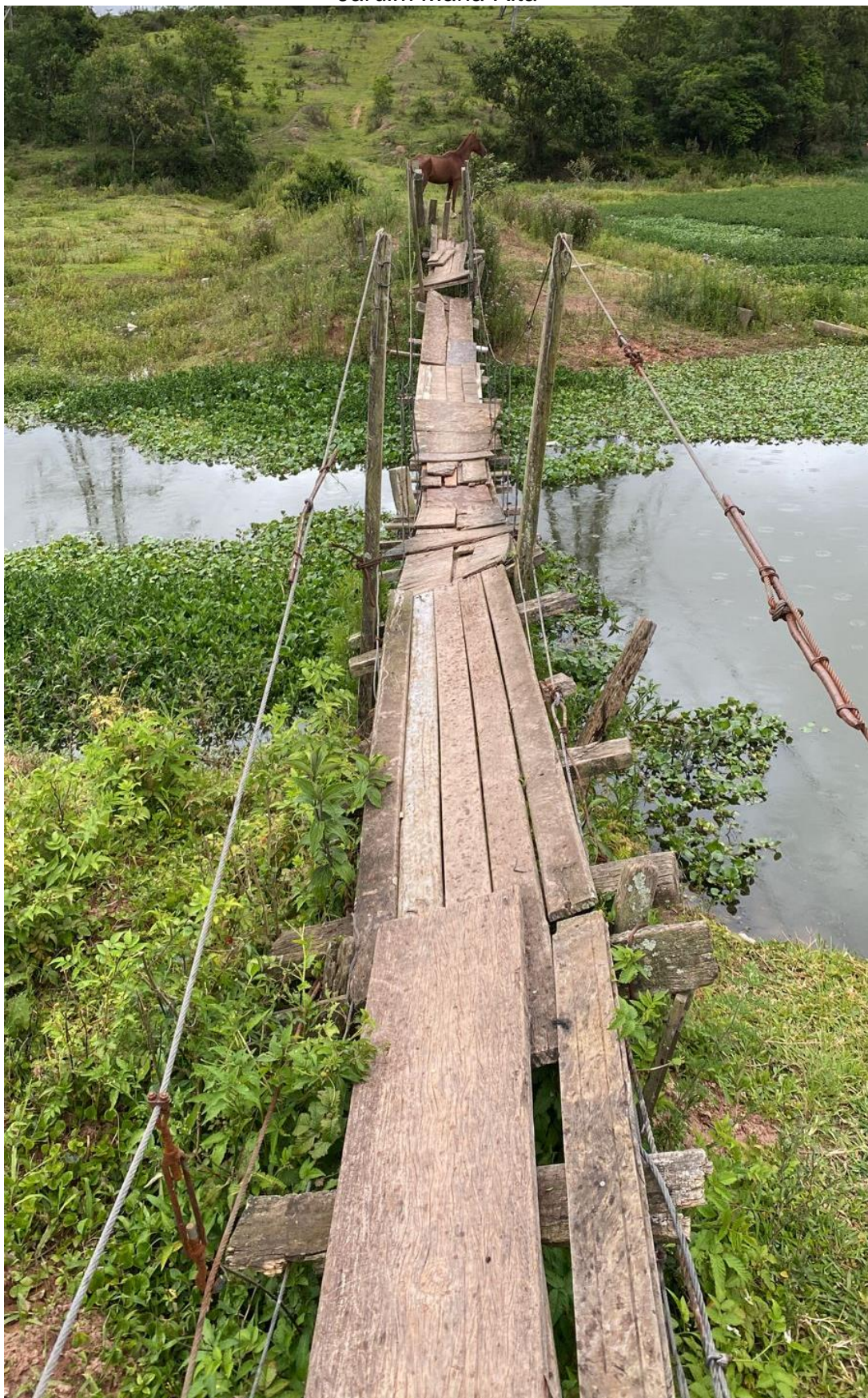
Figura 20. Fotografia da ponte de madeira improvisada utilizada por moradores do Jardim Maria Rita
