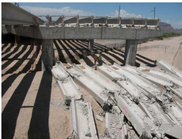
Figura 28: Exemplo de falha por instabilidade lateral durante a montagem.
