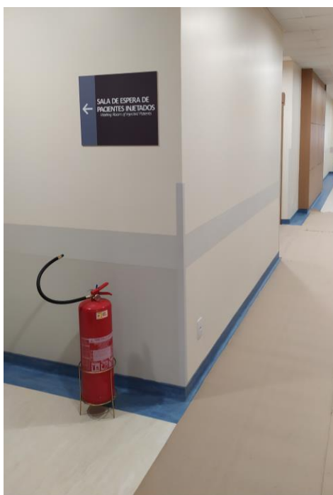
Figura 43 - Corredor com bate-macas e extintor
