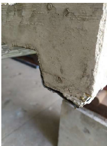
Figura 6.15: Separação localizada entre forma de aço e concreto
