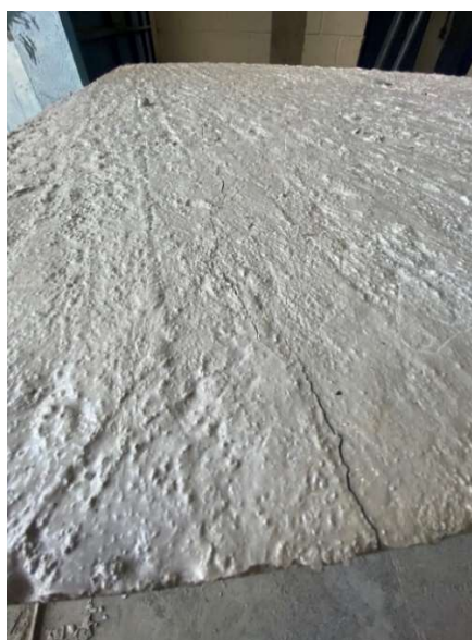
Figura 6.26: Fissuras transversais VMPP
