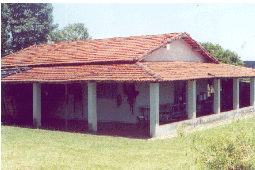
Foto 14 – Casa sede da fazenda (em mal estado de conservação)
