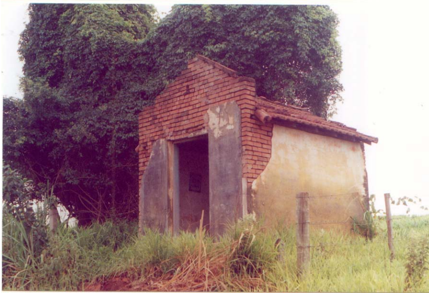
Foto 19 – Ruína de uma construção na área de sede da fazenda
