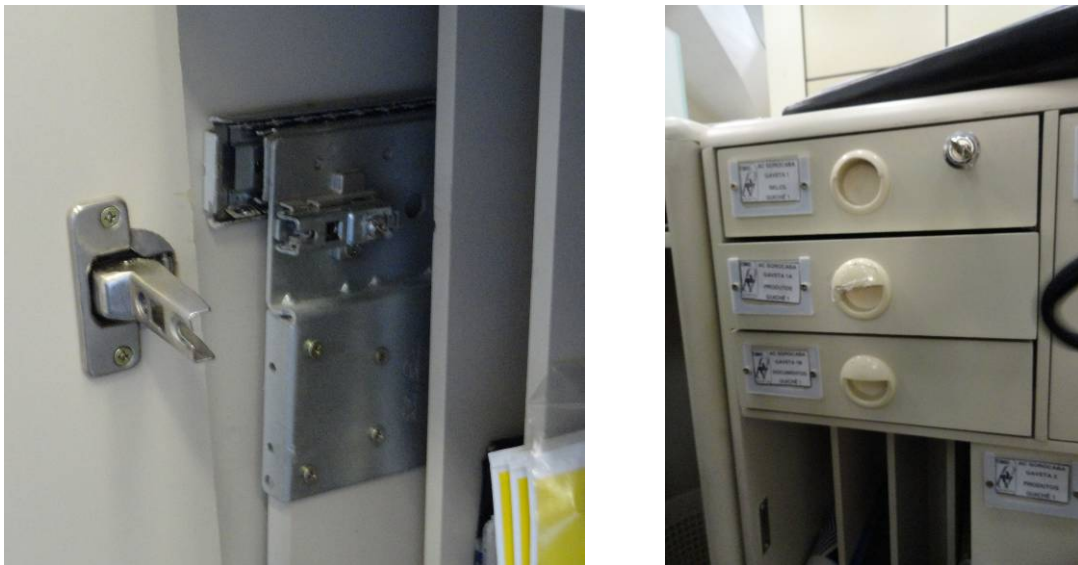
Figura 54 Acabamentos danificados – dobradiça (à esquerda) e puxadores (à direita).
