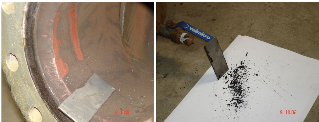
Figura 2.11: Pó preto nas paredes internas da tubulação (DIAS, 2003)
