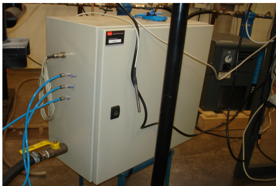
Figura 3.31: Caixa de automação com os sensores
