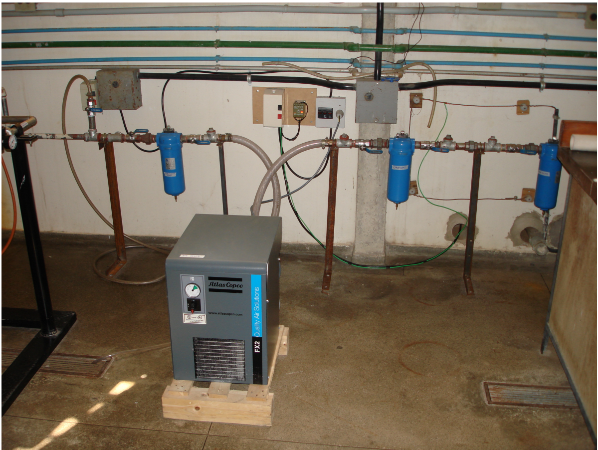
Figura 3.28: Sistema de preparação do ar comprimido composto de pré filtro, filtro coalescente fino, secador de ar comprimido e filtro coalescente super fino
