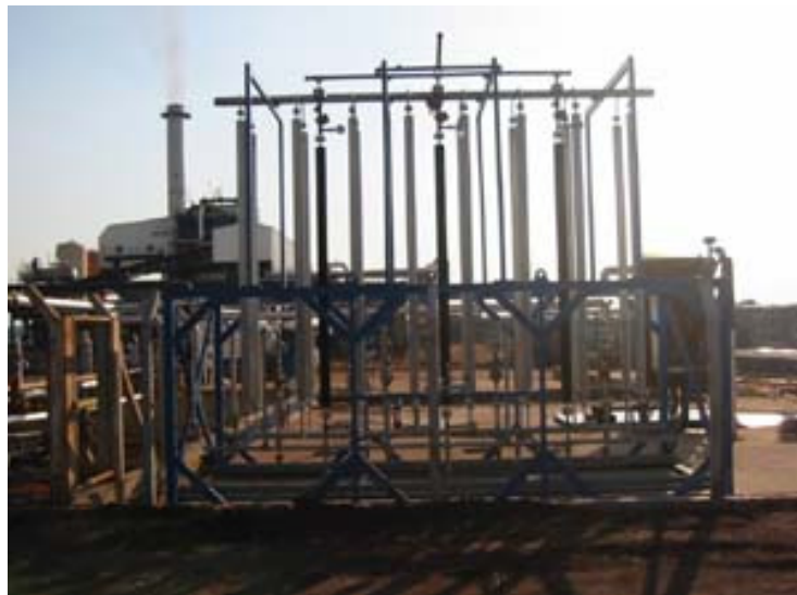
Figura 2.4: Unidade de descompressão de GNC (GÁS BRASIL, 2006)
