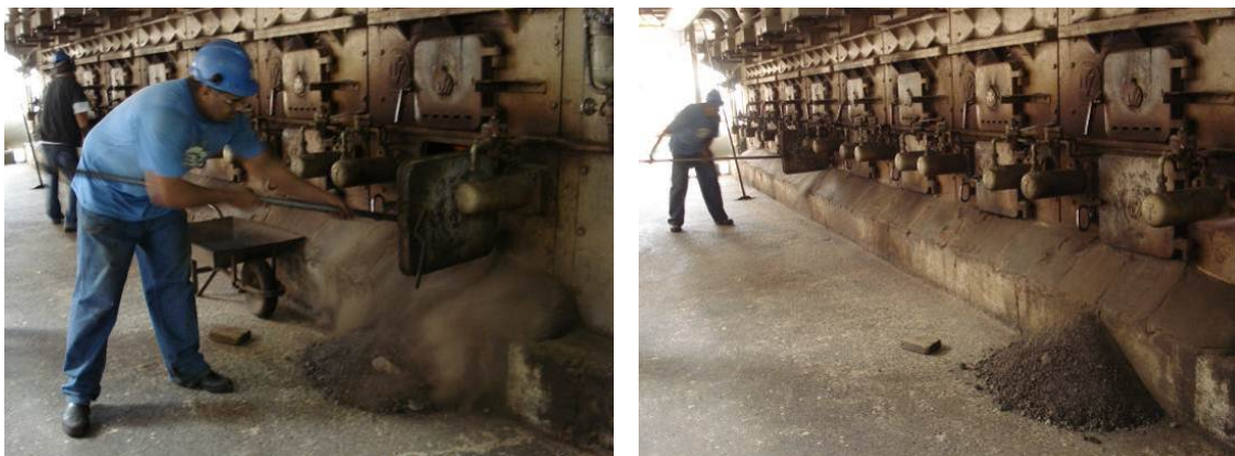
Figura 3.3. Retirada da cinza da caldeira (esquerda) e secagem da cinza ao ar livre (direita) – usina na cidade “J”
