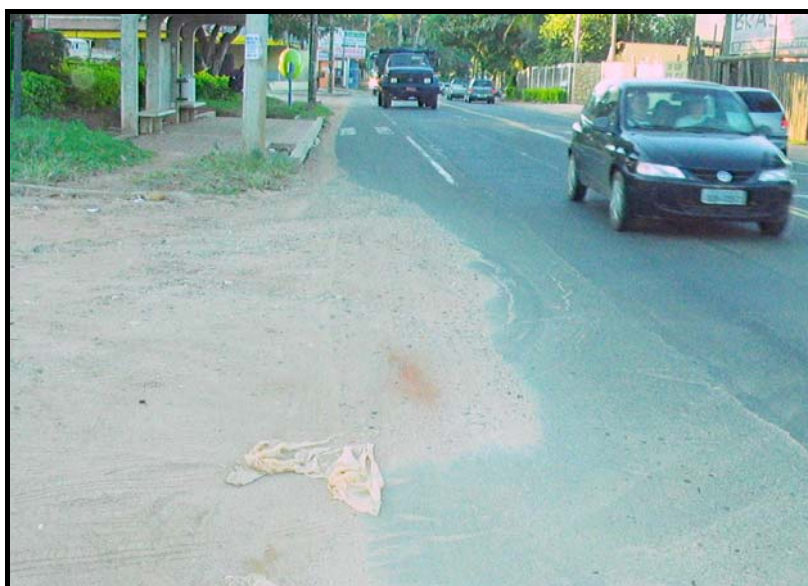
Figura 9.3: Areia arrastada de via não pavimentada.
