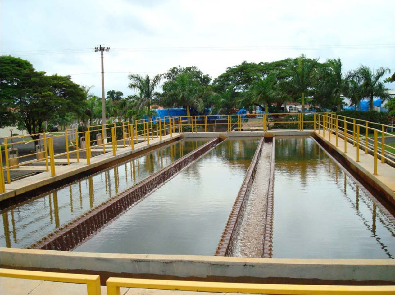
Figura 4.5 – Foto dos decantadores da ETA 2.
