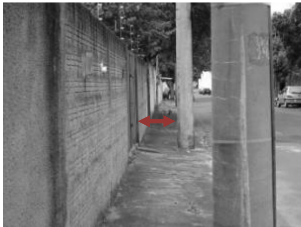
Foto E3-8 Calçada estreita, e posicionamento inadequado do mobiliário.
