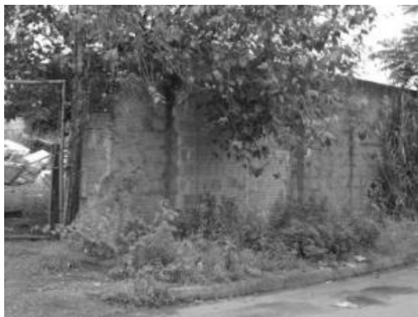
Foto E3-26 Calçada em péssimo estado de conservação.
