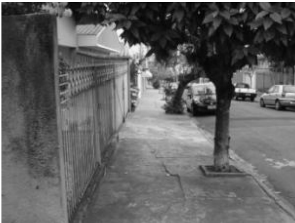
Foto E6-15 Calçamento em mau estado de conservação
