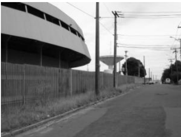
Foto E3-5 Calçada tomada pela vegetação, na parte traseira do Ginásio.
