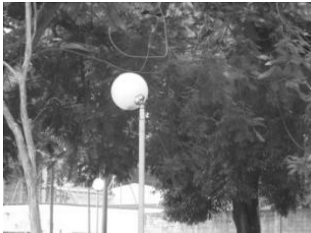
Foto E2-22 Iluminação da praça em péssimo estado de conservação.
