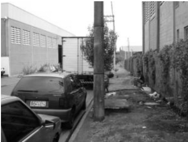
Foto E3-21 Calçada em péssimo estado de conservação.
