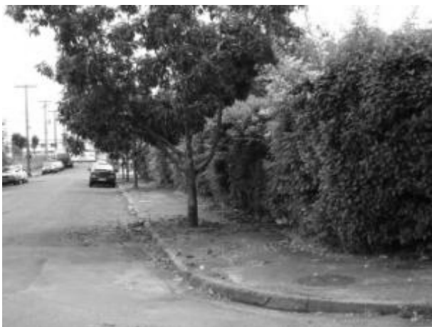
Foto E3-25 Obstruções no passeio causadas por plantio inadequado de vegetação.
