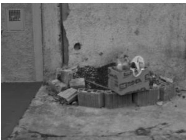
Foto E5-15 Utilização da calçada com depósito de material e entulho.
