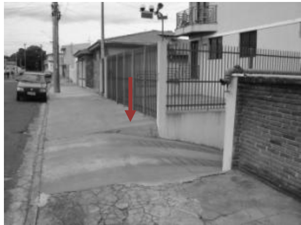
Foto E6-22 Acesso para vagas em lote lindeiro – degrau no passeio
