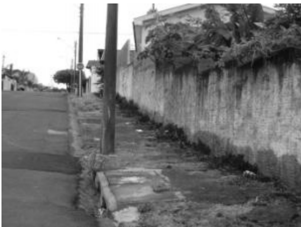
Foto E5-13 Calçada em mau estado de conservação.
