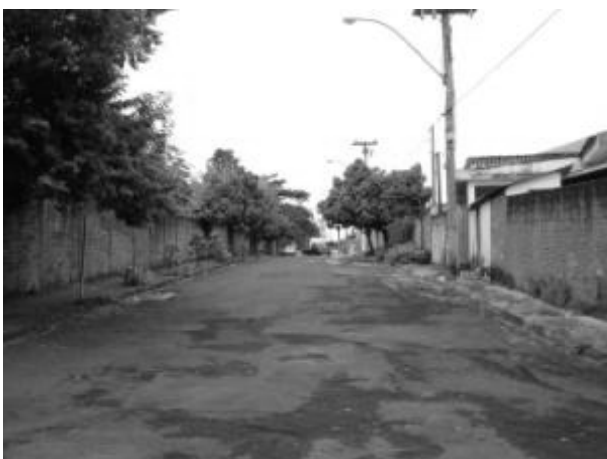
Foto E5-27 Via de veículos e pedestres em mau estado de conservação.
