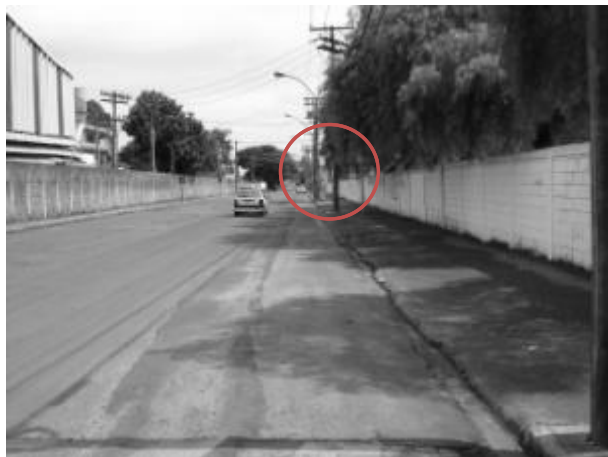
Foto E2-14 Sinalização de lombada escondida sob as folhas
