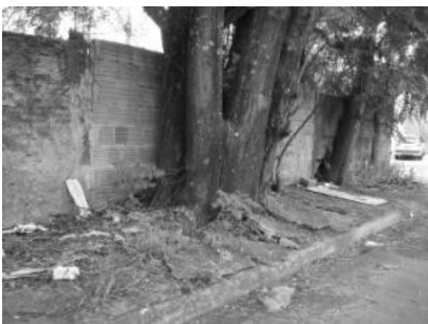
Foto E3-27 Árvores obstruindo o passeio.
