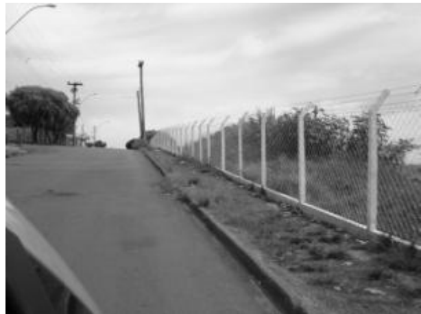
Foto E1-22 Calçamento com péssimo estado de conservação.
