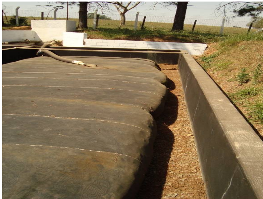
Figura 49 - Detalhe da área de drenagem dos “bag”s. Fonte: SABESP (2010).
