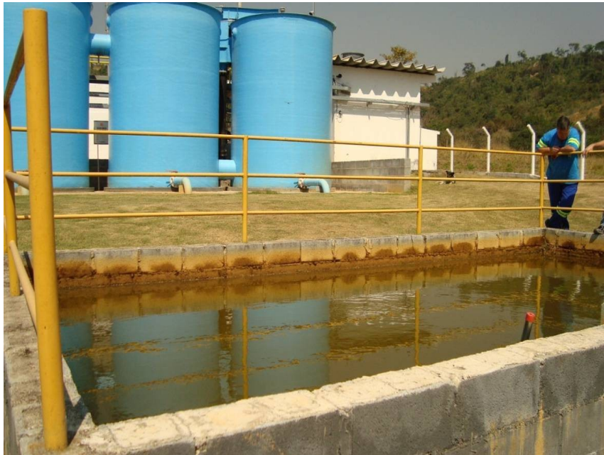
Figura 51 - Tanque de decantação do lodo na ETA Itupeva - SP. Fonte: SABESP (2010).
