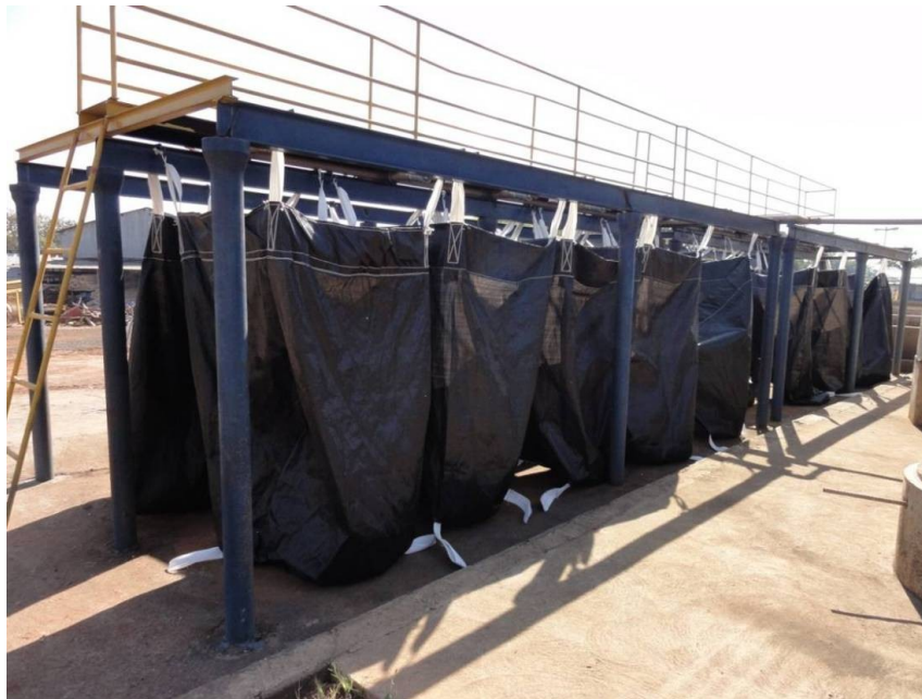
Figura 27 - Disposição dos “bag”s verticais e abertos, sendo utilizados para o desaguamento do lodo na ETA. Fonte: Pessoa (2007).
