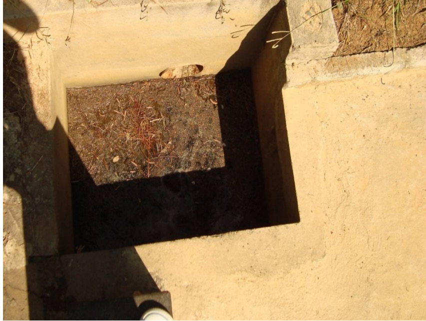
Figura 48 - Poço de recebimento dos efluentes. Fonte: SABESP (2010).
