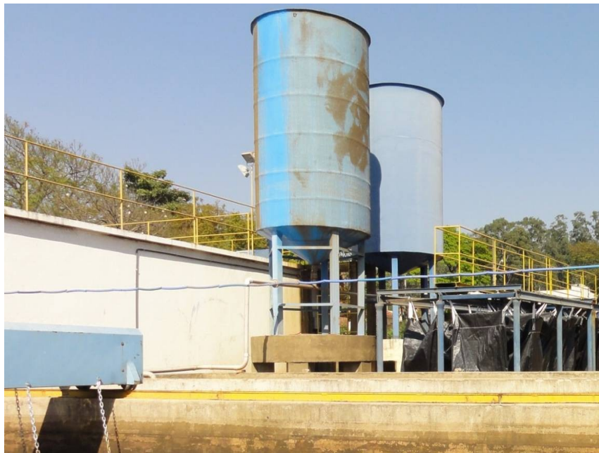
Figura 24 - Decantadores para o Lodo da ETA em Nova Odessa-SP. Fonte: BioCiclo (2010).
