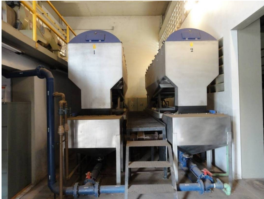
Figura 33 - Foto dos Adensadores de Lodo da ETL Capim Fino. Fonte: SEMAE (2010).
