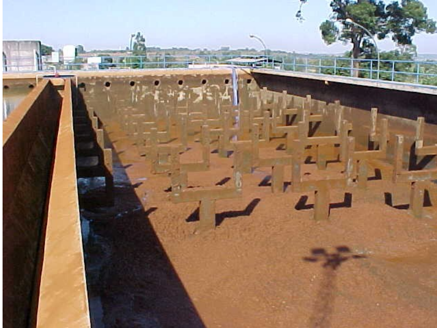
Figura 05 - Decantadores da ETA em funcionamento e no início da limpeza - Fonte: ACHON (2008).
