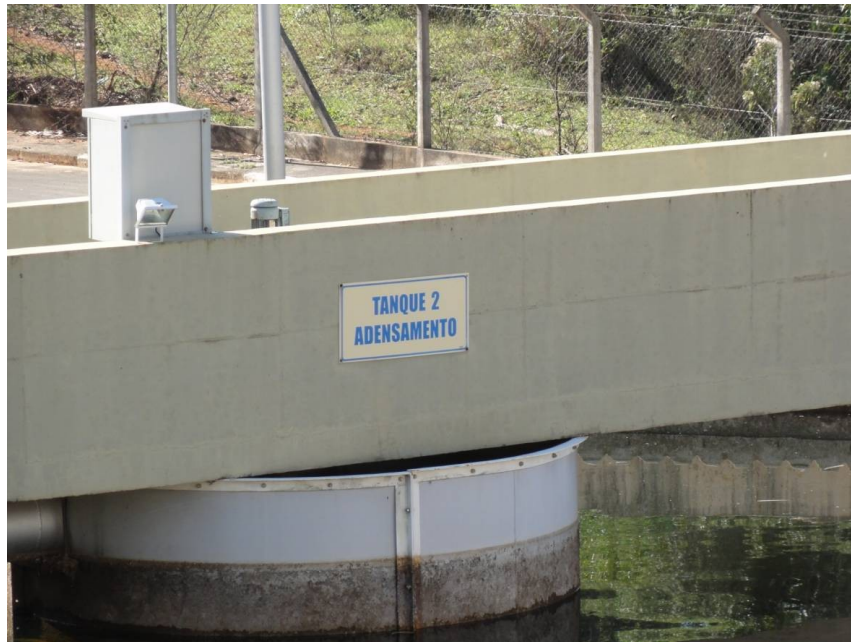
Figura 38 - Detalhe do tanque de adensamento da ETL na SANANA/Campinas. Fonte: SANASA (2010).
