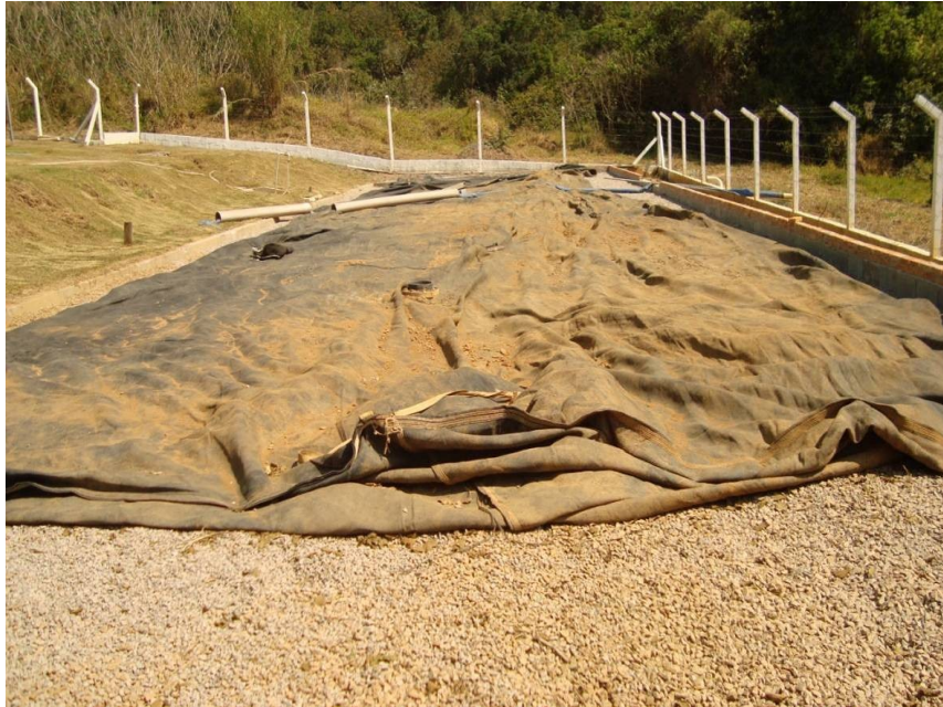
Figura 53 - Detalhe do local onde está instalado o “bag” para acondicionamento do lodo na ETA São José em Itupeva - SP. Fonte: SABESP (2010).
