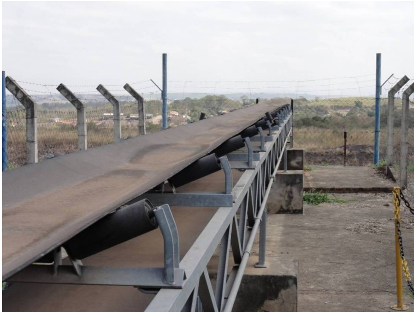
Figura 35 - Esteira de transporte de lodo para o aterro próprio da ETA. Fonte: BioCiclo (2010).
