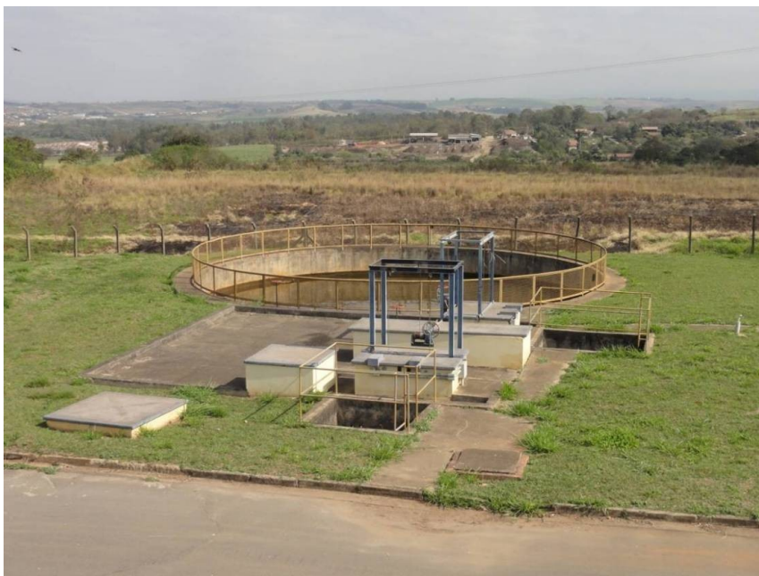
Figura 36 - Tanque de Clarificação da ALF da ETA Capim Fino. Fonte: BioCiclo (2010).
