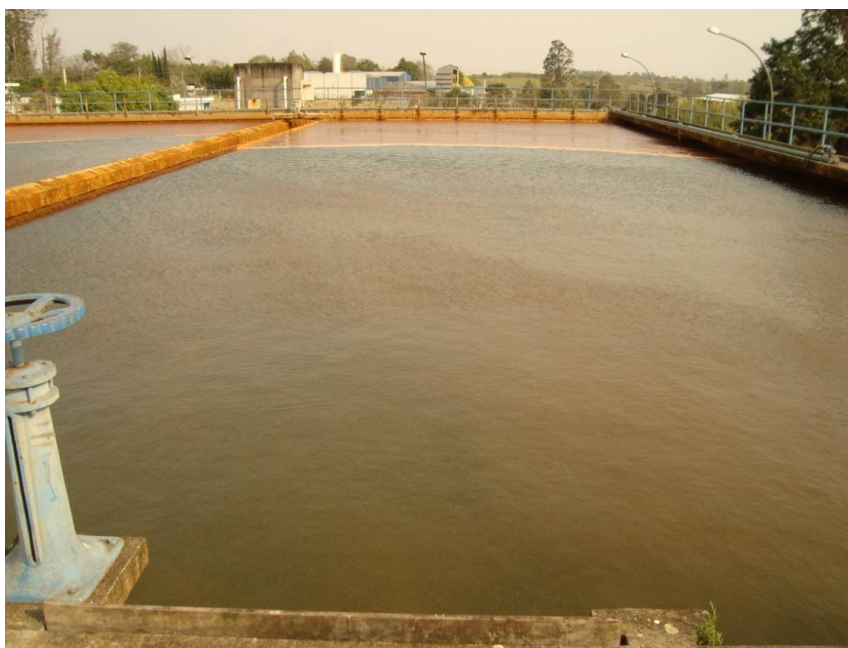
Figura 42 - Vista parcial do decantador na ETA Rio Claro - SP. Fonte: DAAE Rio Claro (2010).
