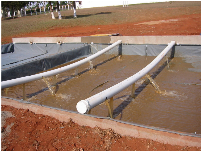
Figura 10 - Chegada do lodo nos leitos de drenagem - ETA Cardoso - SP. Fonte: Fontana (2004)
