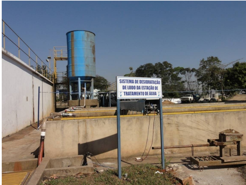
Figura 23 - Vista Geral do Sistema de Desaguamento de lodo da ETA Nova Odessa. Fonte: BioCiclo (2010).
