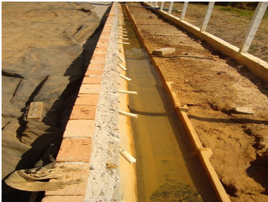
Figura 54 - Canaleta coletora do efluente drenado dos “bag”s. Fonte: SABESP (2010).
