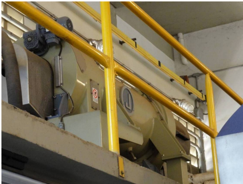
Figura 34 – Foto da Centrífuga existente na ETL-Capim Fino. Fonte: BioCiclo (2010).
