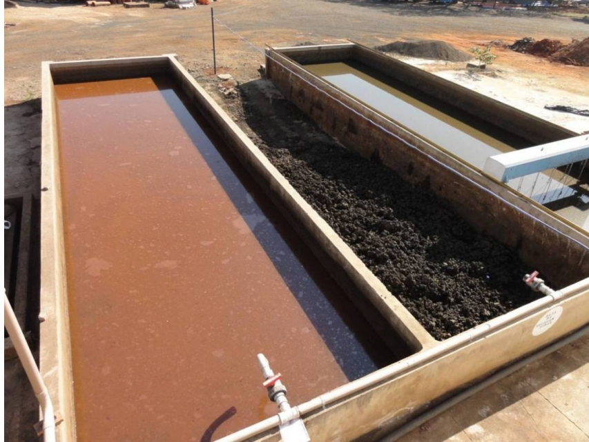
Figura 25 - Leitos de secagem do lodo de ETA. Fonte: BioCiclo (2010).
