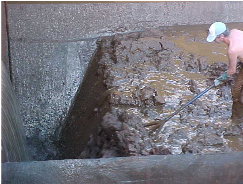
Figura 07 - Procedimento de limpeza do lodo acumulado no fundo dos decantadores - Fonte: Achon (2008)
