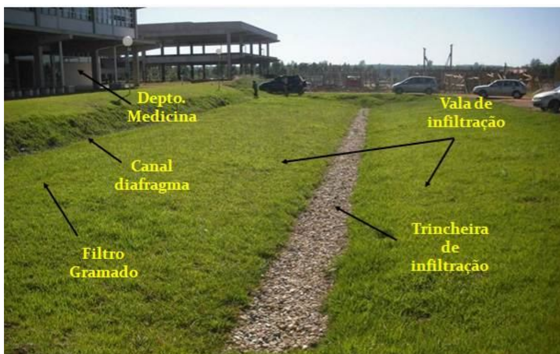
Figura 13: Sistema Filtro-Vala-Trincheira de infiltração construídos no campus da UFSCar. Fonte: Gutierrez et al., 2010.
