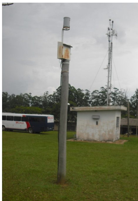
Figura 20: Pluviógrafo digital instalado em campo
