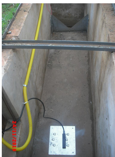
Figura 21: Medidor de vazão instalado em campo
